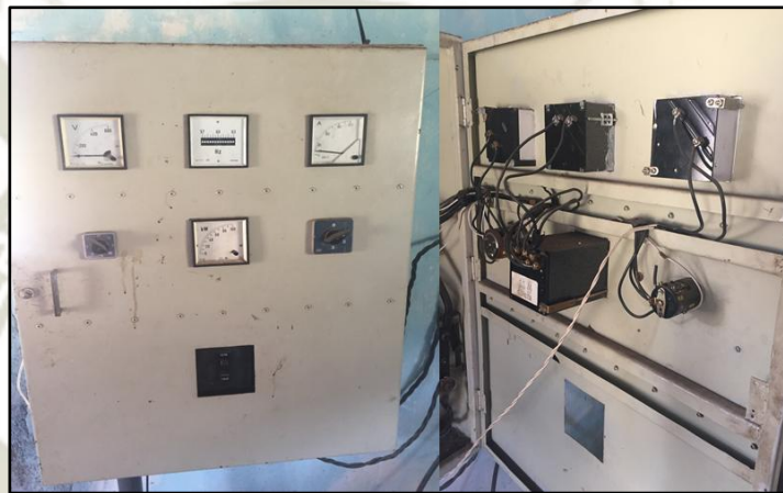
Figura 3.12. Estado actual del tablero de control por fuera
