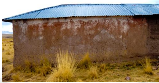
Foto 47: tomada a una pared lateral de la casa de la familia Imata – Fuente propia.
