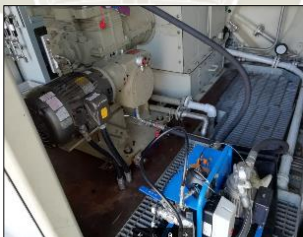
Figura 13. Conexionado reductor de velocidad a equipo de dializado de aceite.
