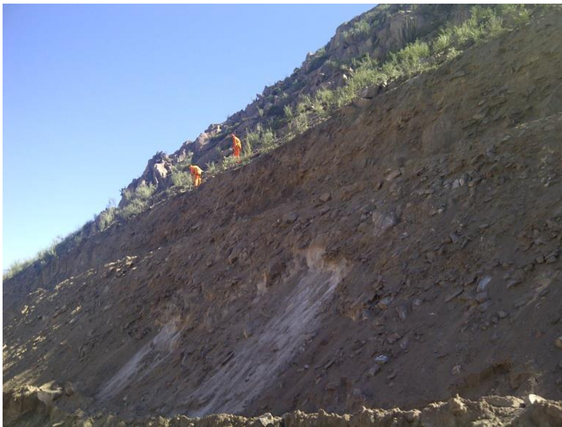
Foto 08: Desquinche de talud
