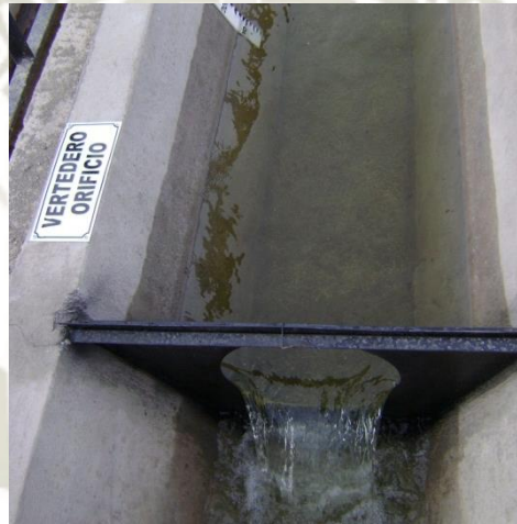
FOTOGRAFÍA No. 12 Vista de un Vertedero Circular (Instalación en Campo).
