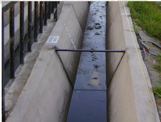
FOTOGRAFÍA No. 29. Secciones de Control Manning.
