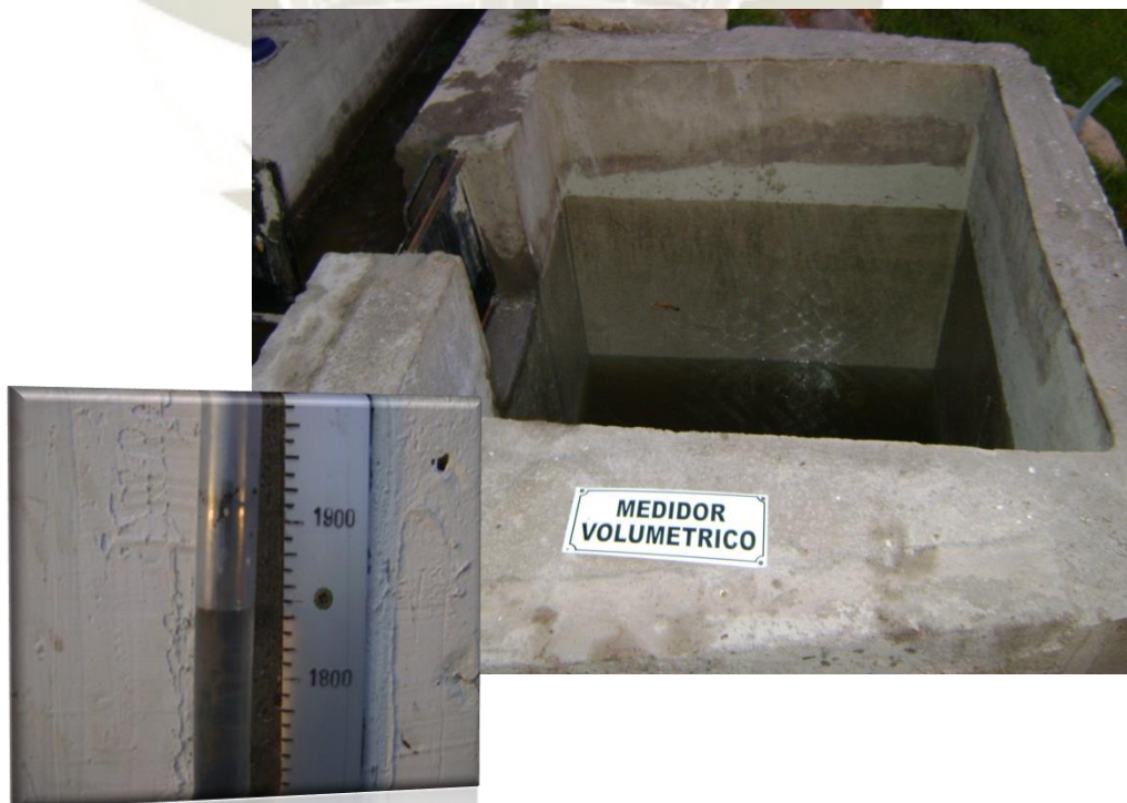
FOTOGRAFÍA No. 42. Reservorio, evaluación de medidor.
