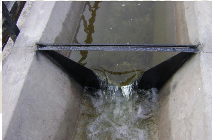
FOTOGRAFÍA No. 22. Vertedero Triangular.
