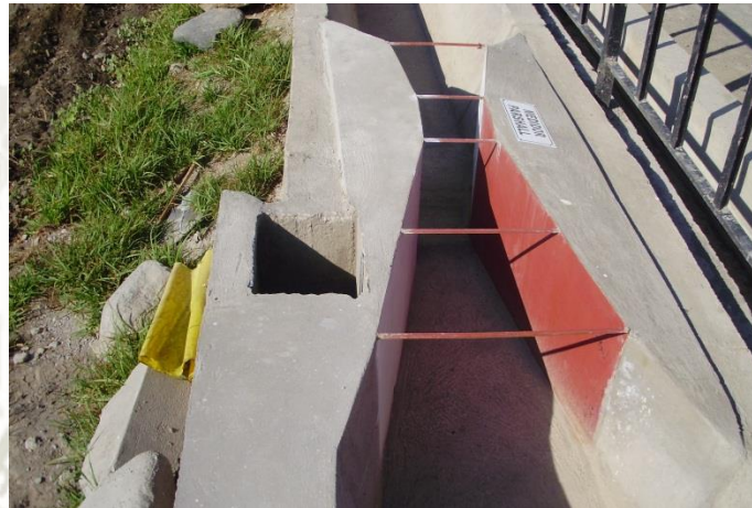
FOTOGRAFÍA No. 30. Aforador Parshall.
