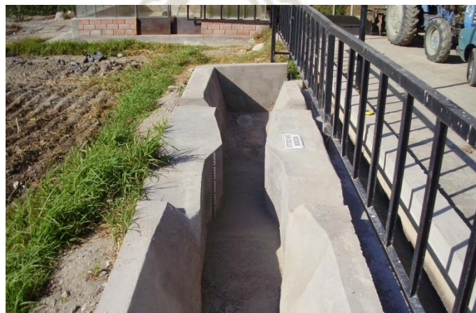
FOTOGRAFÍA No. 31. Aforador Sin Cuello.
