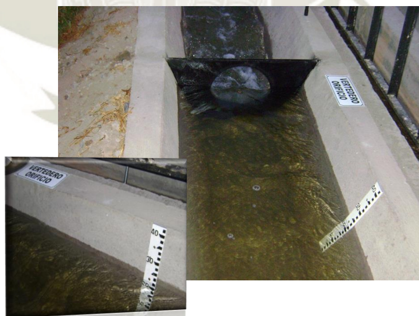
FOTOGRAFÍA No. 38. Vertedero Orificio, evaluación de medidor.
