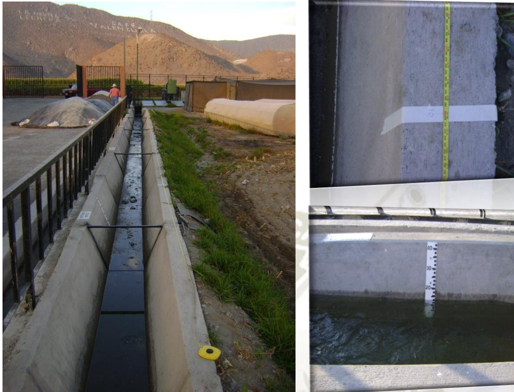
FOTOGRAFÍA No. 43. Flotadores, evaluación de medidor.
