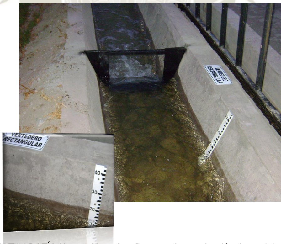
FOTOGRAFÍA No. 36. Vertedero Rectangular, evaluación de medidor.
