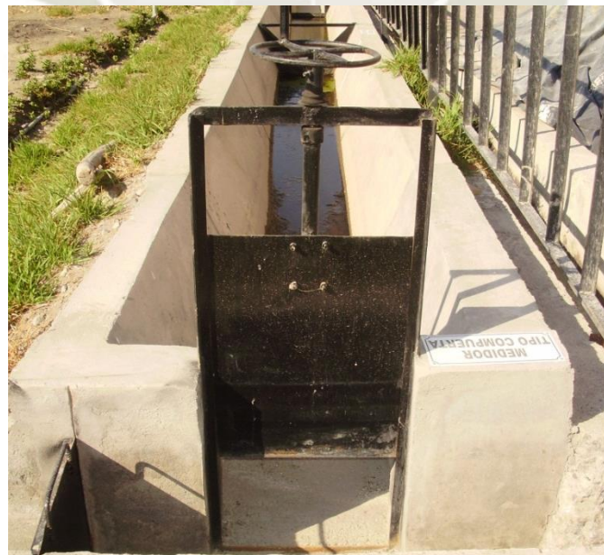
FOTOGRAFÍA No. 21. Compuerta.
