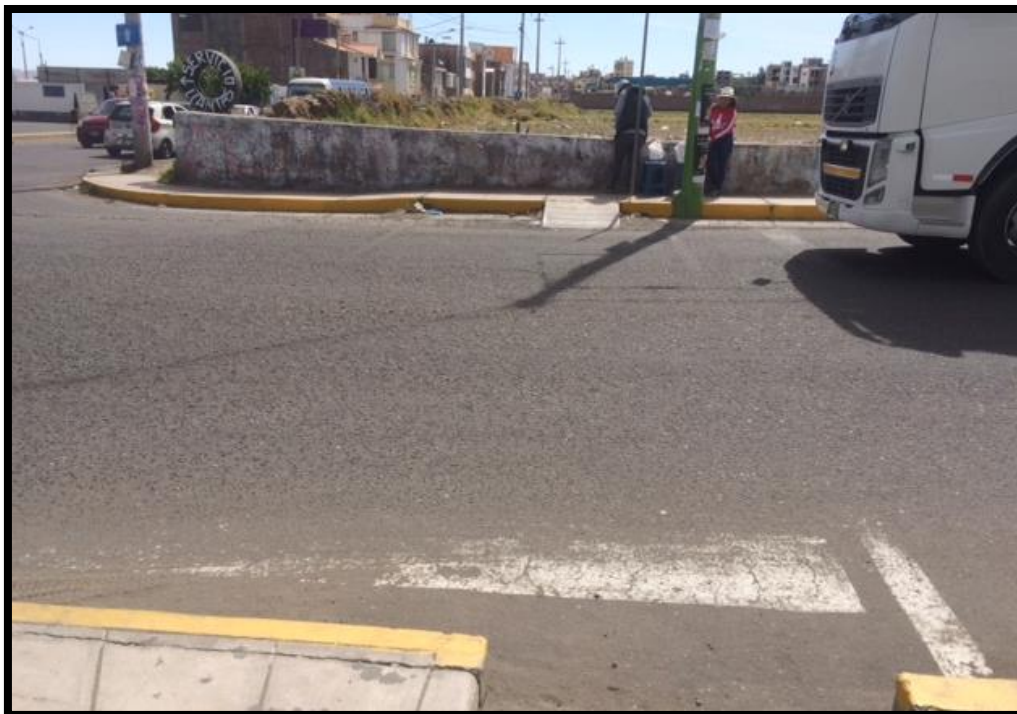
Figura 3.42 – Estado de Señales Horizontales de paso peatonal (Fuente: Elaboración Propia)
