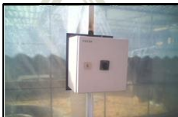
Fotografía 18: Panel de control de riego.
