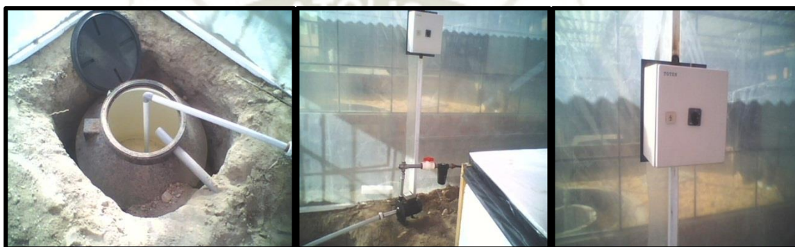
Fotografía 11: Instalaciones eléctricas y de gasfitería.
