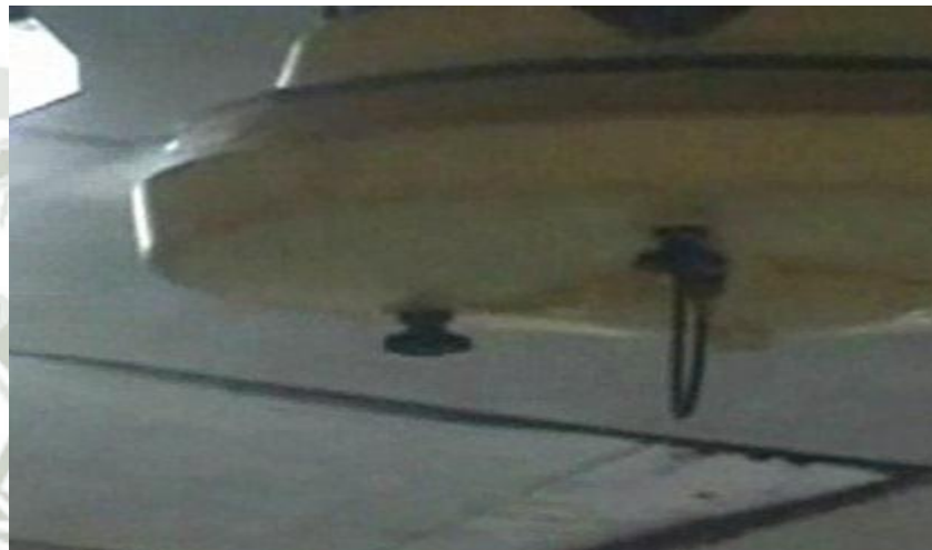
Figura N° 02 Sistema de Humidificación de la planta de Hilandería
