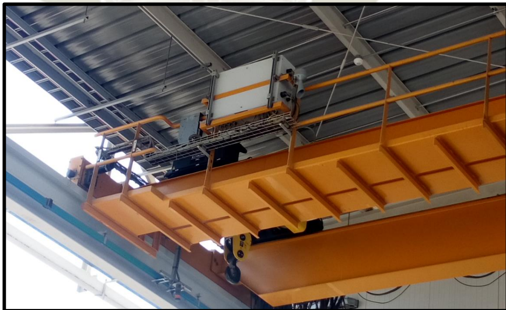
Figura 14 Puente Grúa de 15 Ton
