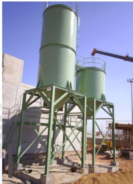
Figura 2-2. Silos de sección circular y pared de chapa lisa formado. por virola del mismo espesor.
