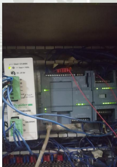
Figura 4-21 Instalación de PLC 1200 Siemens
