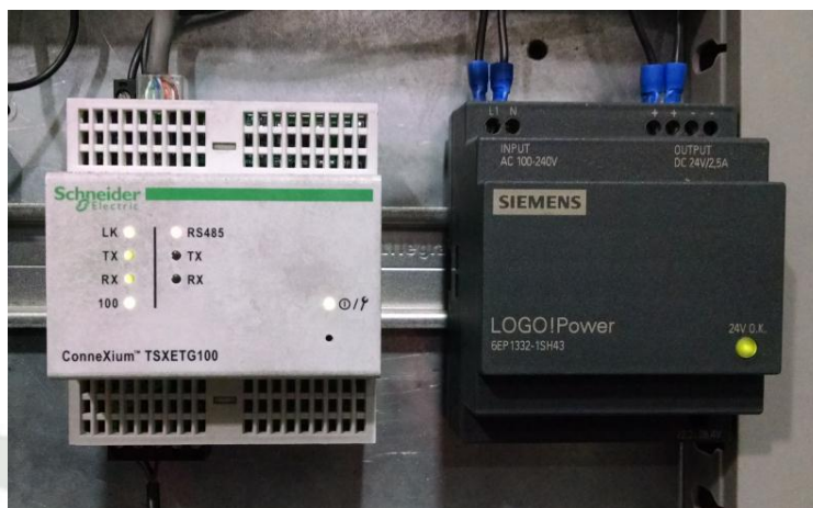
Figura 4-19 Gateway montado en tablero eléctrico
