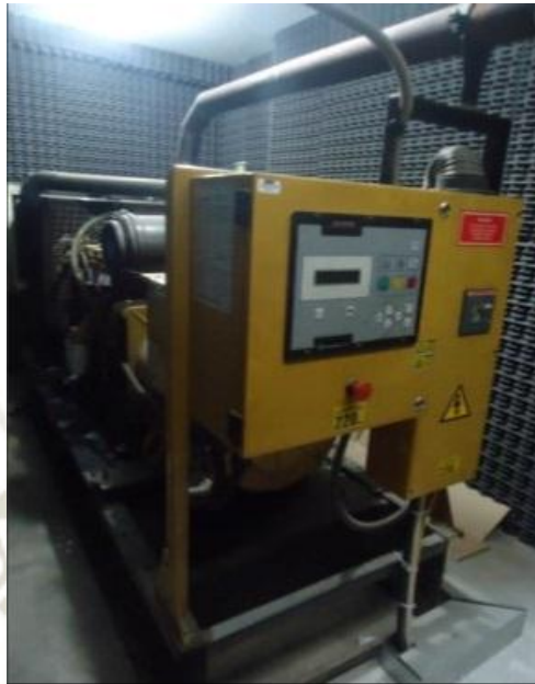
Figura 27. Generador Fuente: Empresa Liner S.A.C.
