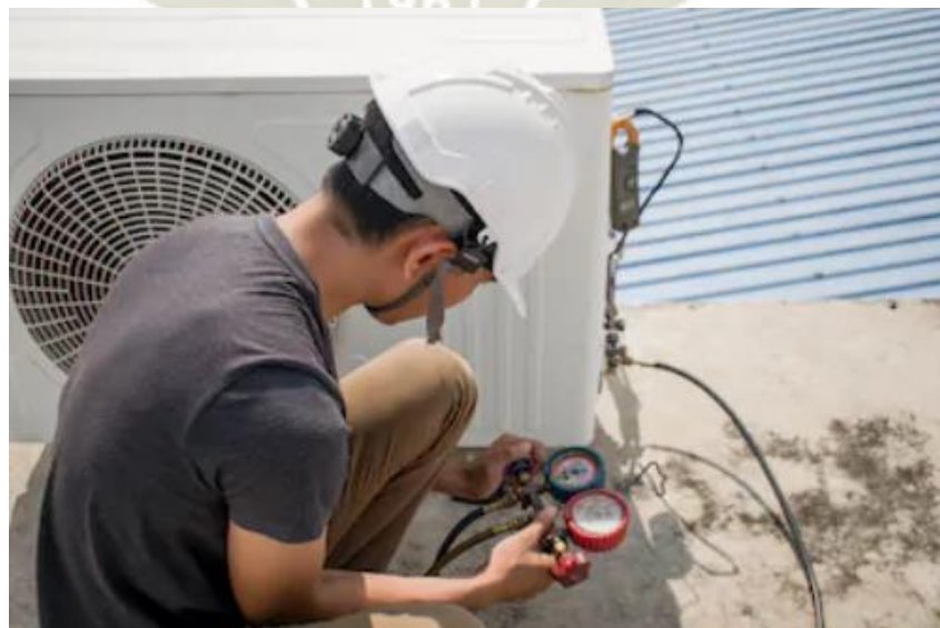
Figura 15 Técnico Especialista en Refrigeración y Electricidad
