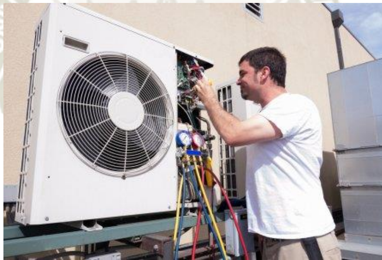
Figura 13 Técnico Especialista en Refrigeración y Electricidad
