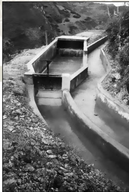
Figura 2.17 Ejemplo de un desarenador antes de la cámara de carga
