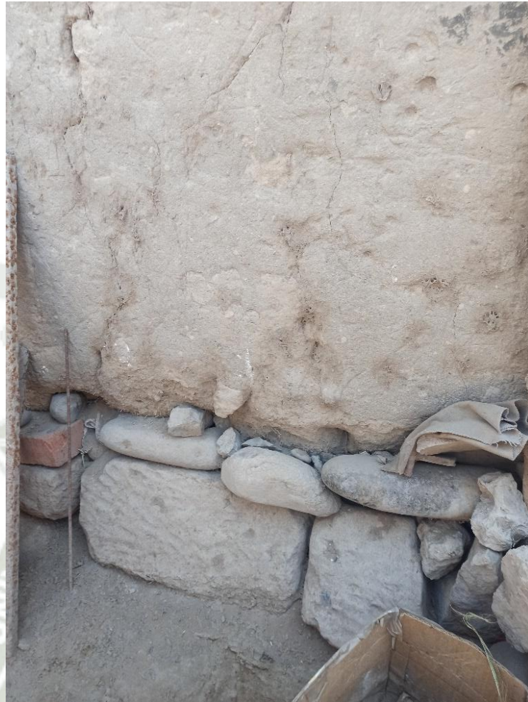
Figura 53 Muro de la vivienda E.P.C-05-1
