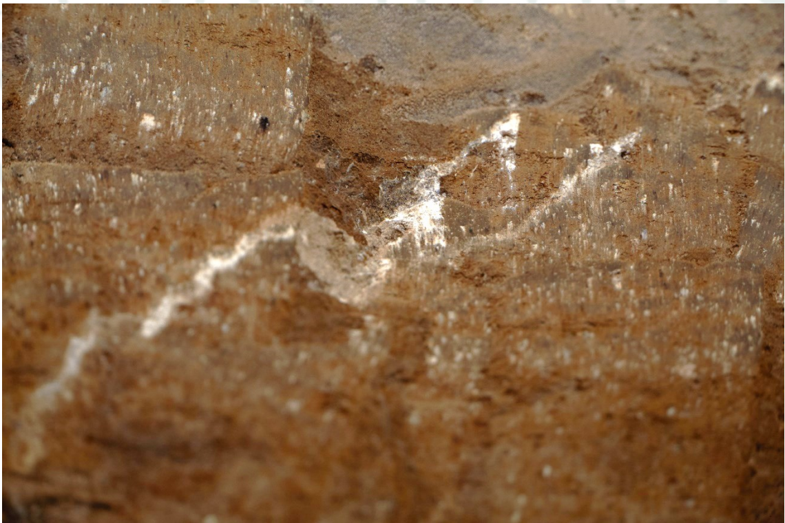
Figura 39. Concrecencia blanca en calicata 1
