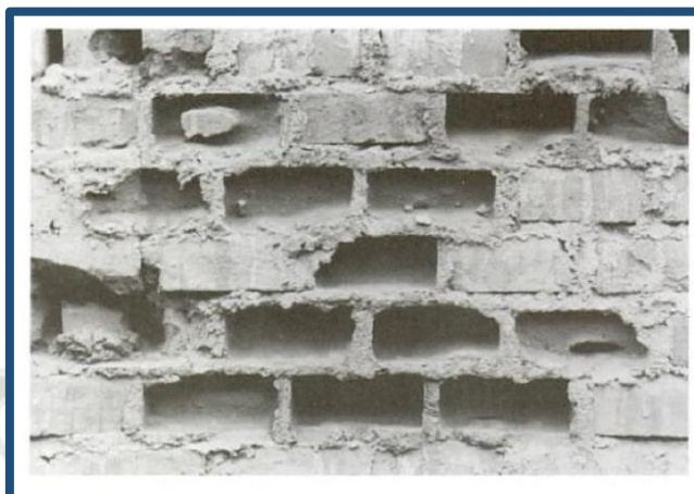
Figura N° 8: Albañilería de unidades de arcilla, destrucción por la acción combinada de sulfatos y humedad
