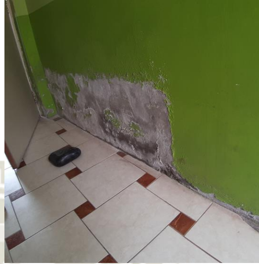
Se observa presencia de salitre en el muro
