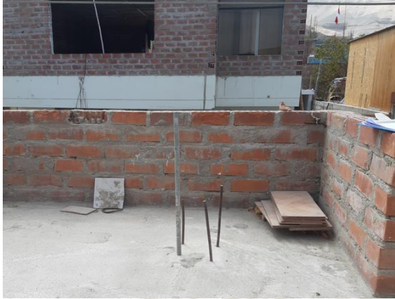
Se observa que el parapeto de la vivienda no presenta arriostramiento alguno.
