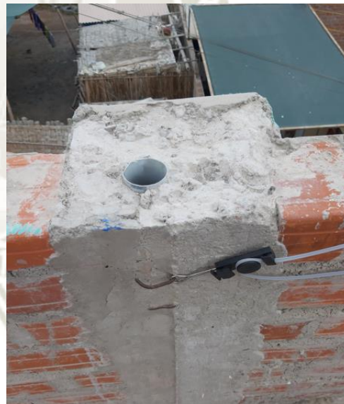
Se observa que la columna es atravesada por una tubería.
