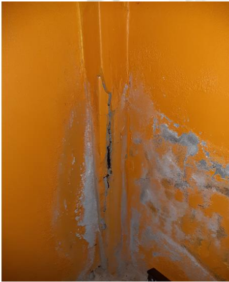
Se observa el acero corroído de la columna, lo cual ha traído como consecuencia el desprendimiento del recubrimiento del elemento.
