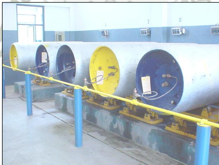
FIGURA N° 10: Batería de cilindros de cloro 907Kg.
