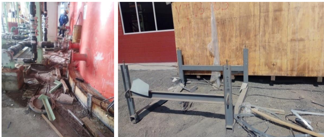
Figura 8: Residuos metálicos y de madera en área de Reactivos
