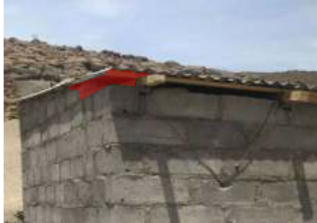
Ilustración 117: Filtraciones de aires en diferentes elementos constructivos entre pared y techo.
