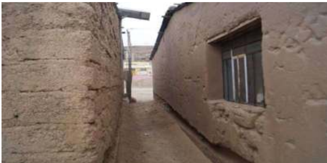
Ilustración 73: Muros Erosionados por lluvia
