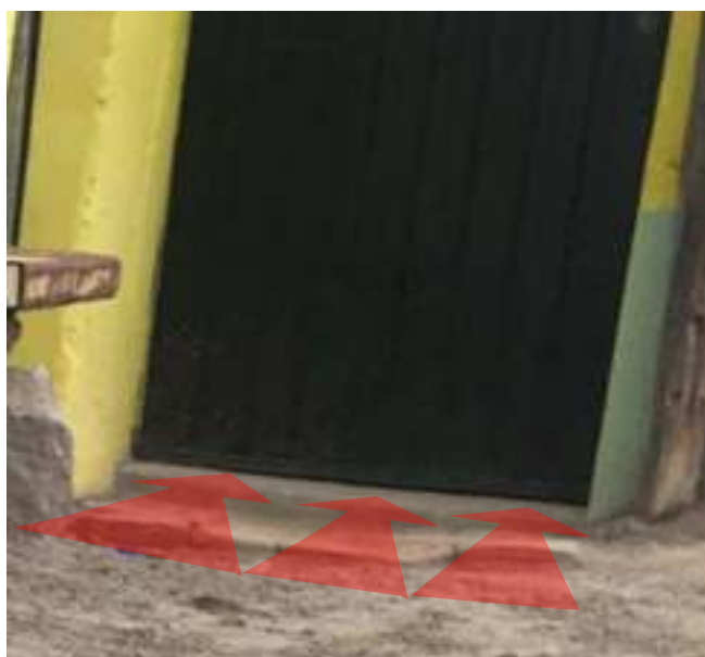
Ilustración 120: Filtraciones de aires no controladas presentes entre la puerta y el piso
