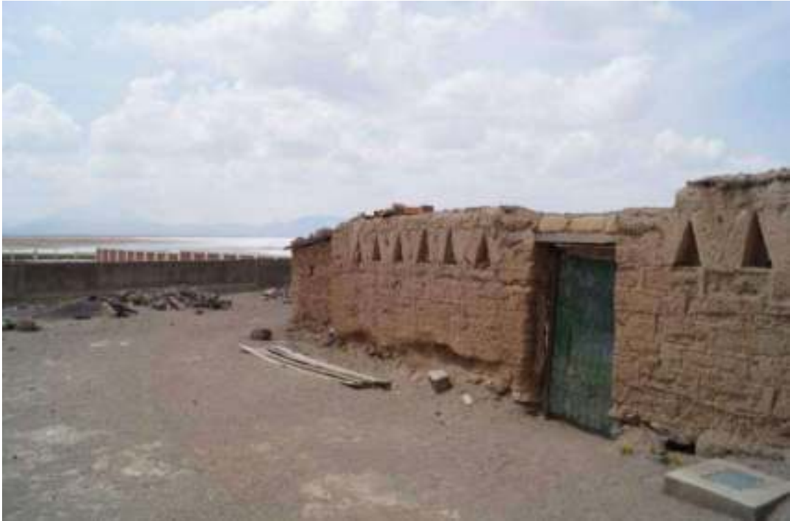
Ilustración 72: Vivienda en Salinas Huito afectada por precipitaciones
