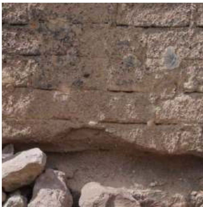
Ilustración 121: Erosión en muros por lluvias
