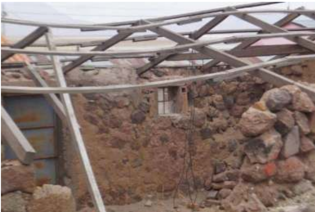
Ilustración 71: Vivienda Colapsada Salinas huito
