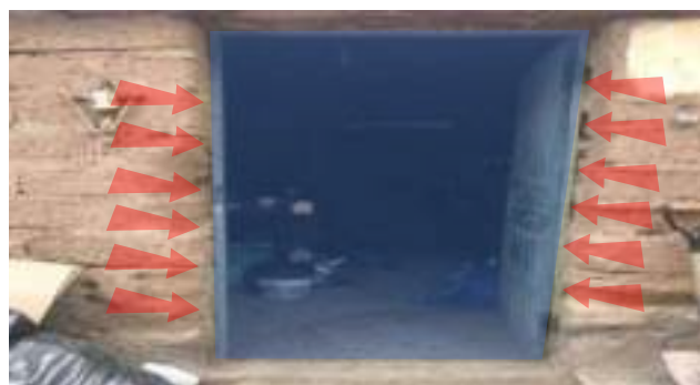
Ilustración 119: Presencia de un elemento con diferente conductividad térmica entre pared y ventana.
