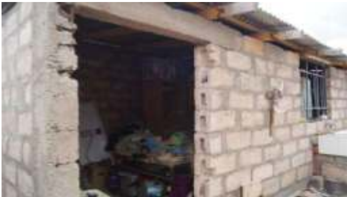
Ilustración 65: Puentes térmicos vivienda periferia
