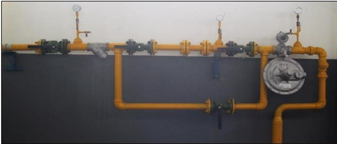
Figura 16. Estación de regulación de presión secundaria.
