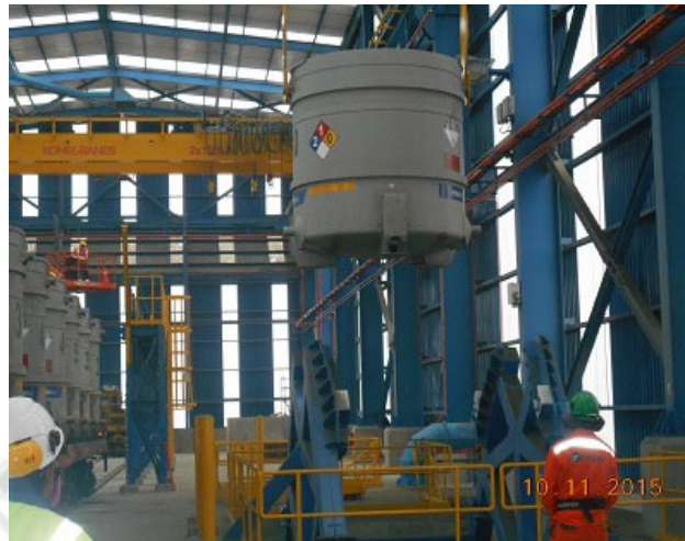
Figura N°28. Traslado de contenedores desde plataforma a volteador de contenedor mediante puente grúa
