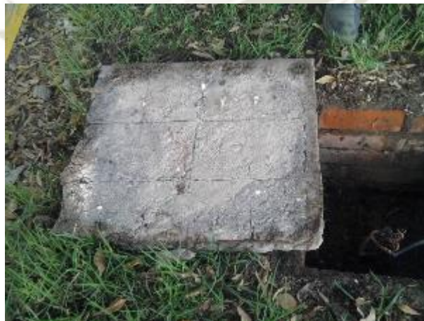
Foto N° 116 Pozos a tierra Fuente: Elaboración propia
