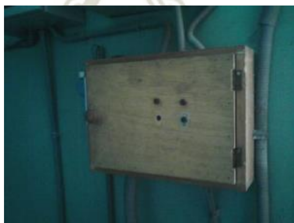
Foto N° 177 (CE4) Tableros eléctricos
