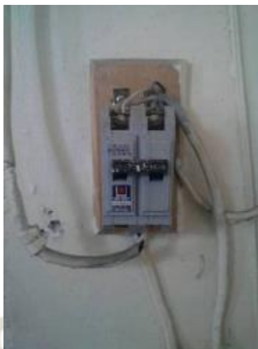
Foto N° 178 (CE4) Tableros eléctricos
