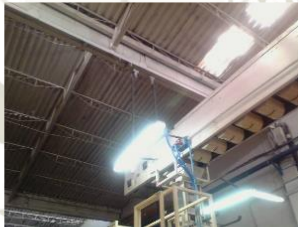
Foto N° 149 (CE2) Equipos eléctricos
