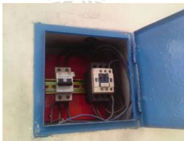
Foto N° 133 (CE2) Tableros eléctricos
