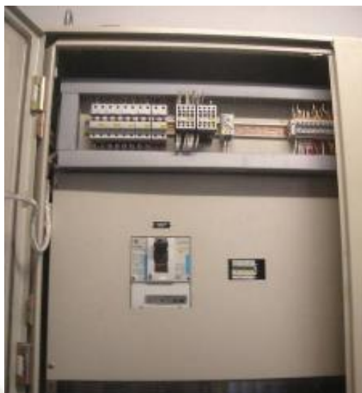
Foto N° 47 Tableros eléctricos Fuente: Elaboración propia
