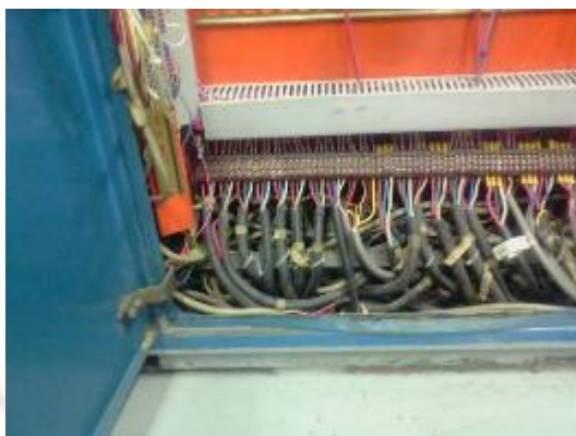
Foto N° 138 (CE2) Tableros eléctricos
