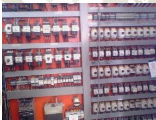
Foto N° 132 (CE2) Tableros eléctricos
