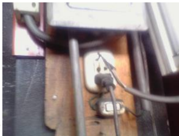
Foto N° 166 (CE3) Tomacorrientes y enchufes
