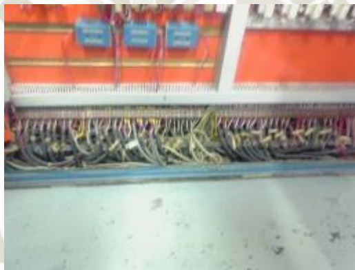
Foto N° 139 (CE2) Tableros eléctricos
