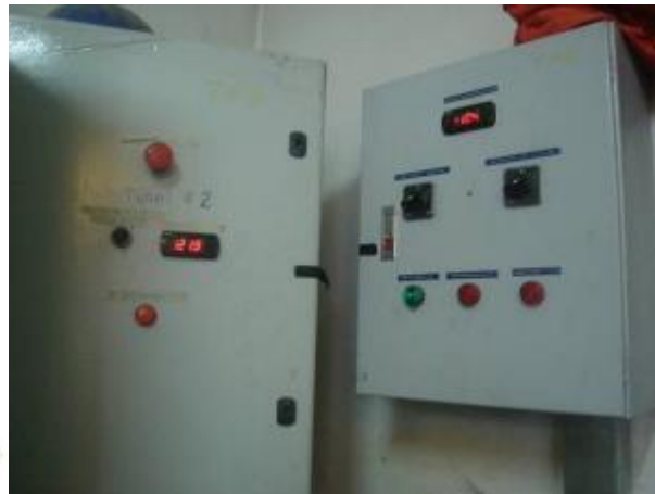
Foto N° 5 Tableros eléctricos Fuente: Elaboración propia
