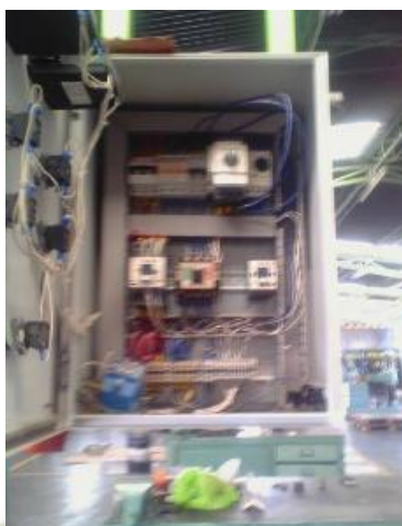
Foto N° 128 (CE2) Tableros eléctricos
