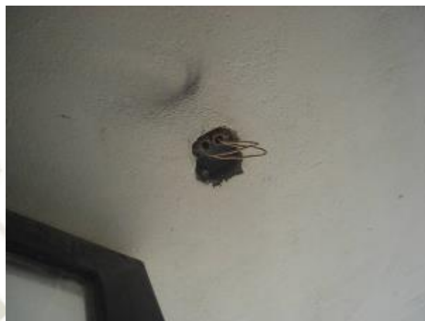
Foto N° 88. Cajas de paso Fuente: Elaboración propia
