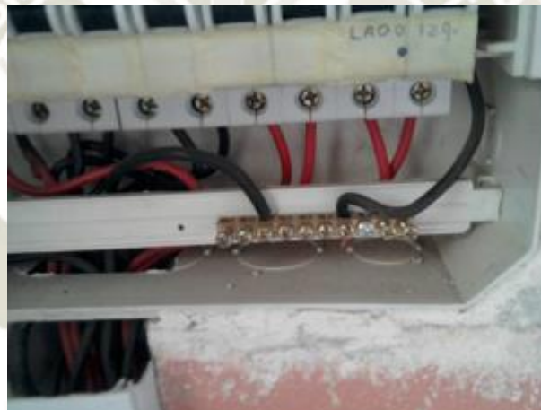
Foto N° 174 (CE4) Tableros eléctricos
