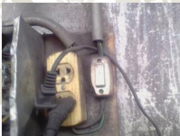
Foto N° 167 (CE3) Tomacorrientes y enchufes
