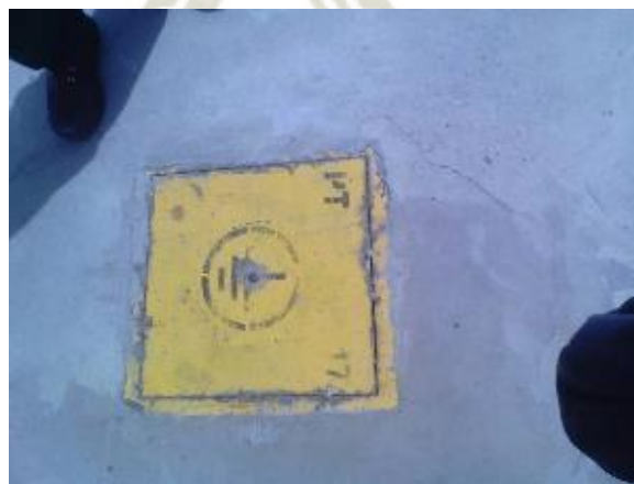
Foto N° 154 (CE2) Pozos a tierra
