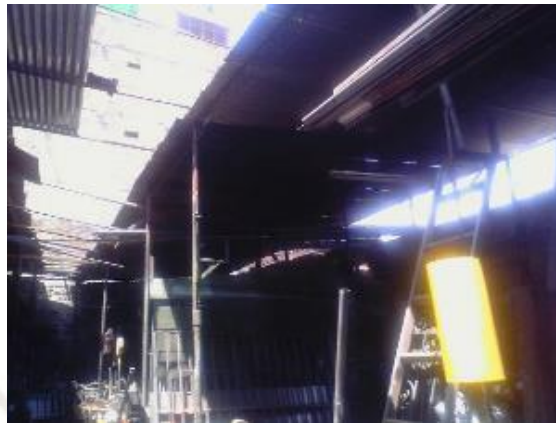
Foto N° 173 (CE3) Luces de emergencia
