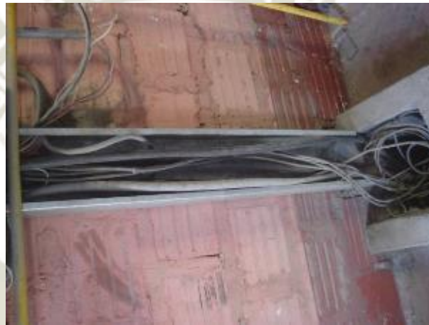
Foto N° 75 Conductores eléctricos Fuente: Elaboración propia
