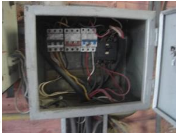
Foto N° 42 Tableros eléctricos Fuente: Elaboración propia
