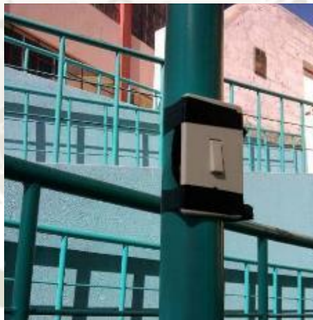
Foto N° 186 (CE4) Interruptores eléctricos
