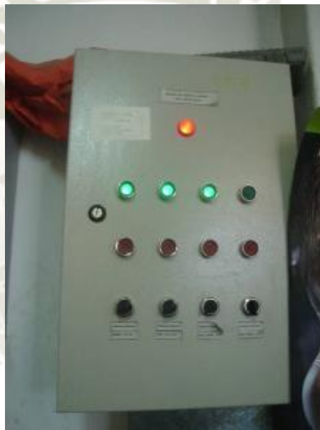
Foto N° 6 Tableros eléctricos Fuente: Elaboración propia
