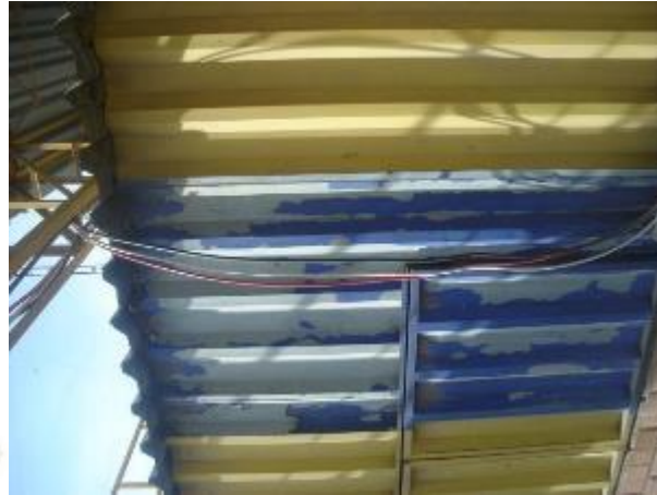
Foto N° 81 Conductores eléctricos Fuente: Elaboración propia
