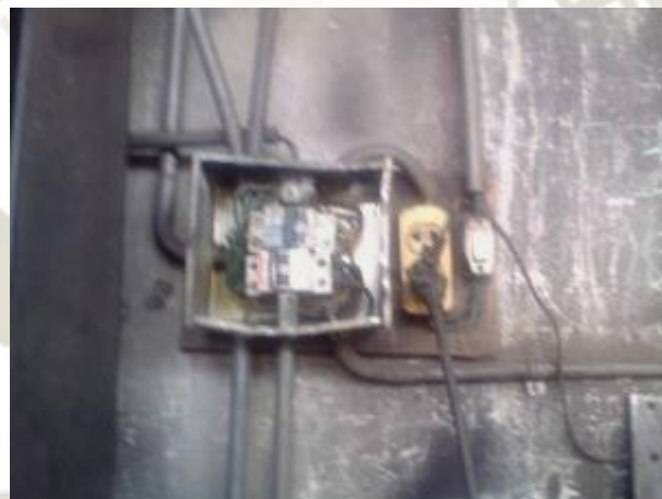
Foto N° 157 (CE3) Tableros Eléctricos
