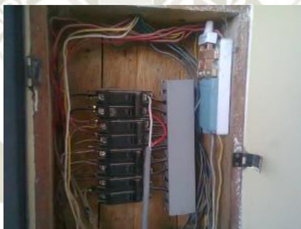
Foto N° 193 (CE4) Tableros eléctricos
