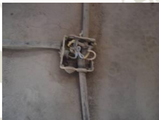
Foto N° 89 Cajas de paso Fuente: Elaboración propia
