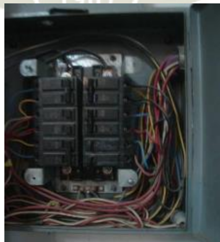
Foto N° 44 Tableros eléctricos Fuente: Elaboración propia
