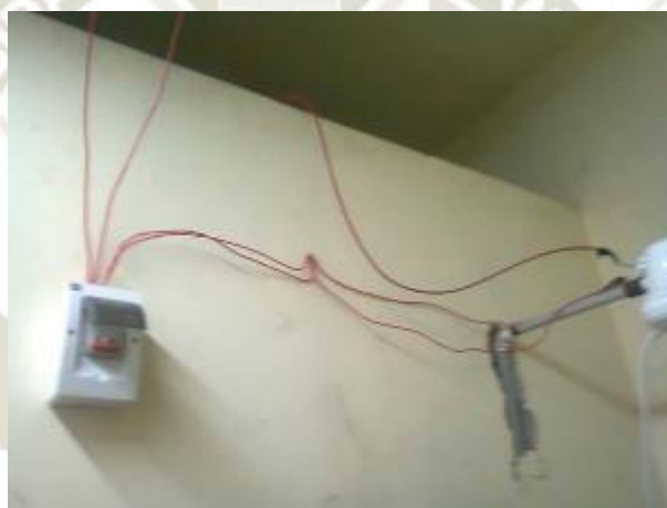
Foto N° 198 (CE4) Conductores eléctricos
