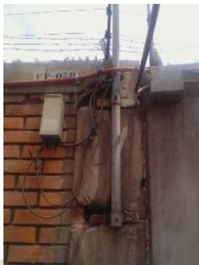
Foto N° 142 (CE2) Conductores electricos
