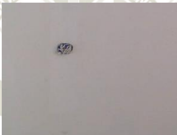
Foto N° 141 (CE2) Caja de paso
