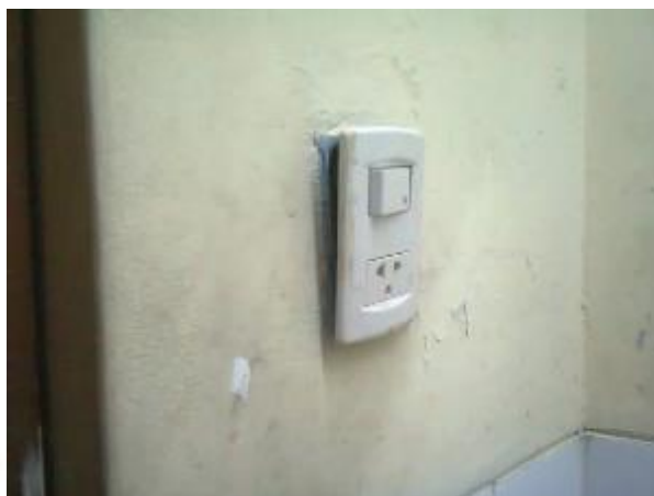
Foto N° 194 (CE4) Interruptores eléctricos
