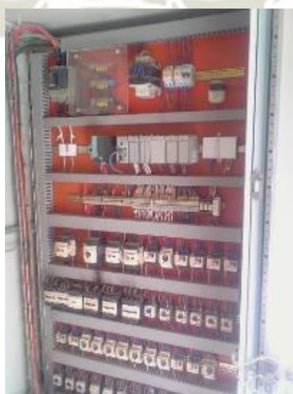
Foto N° 130 (CE2) Tableros eléctricos
