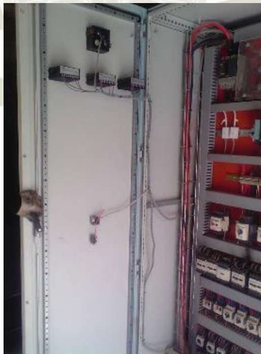
Foto N° 135 (CE2) Tableros eléctricos Fuente: Elaboración propia
