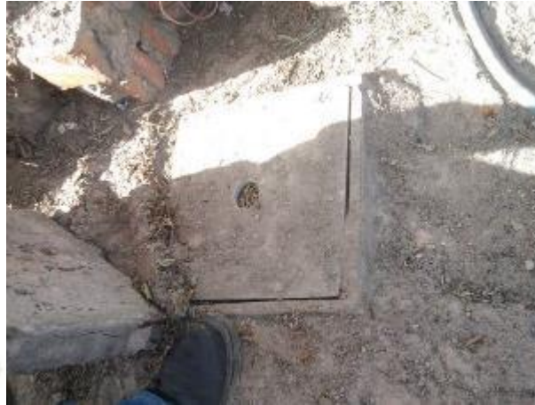
Foto N° 114 Pozos a tierra Fuente: Elaboración propia
