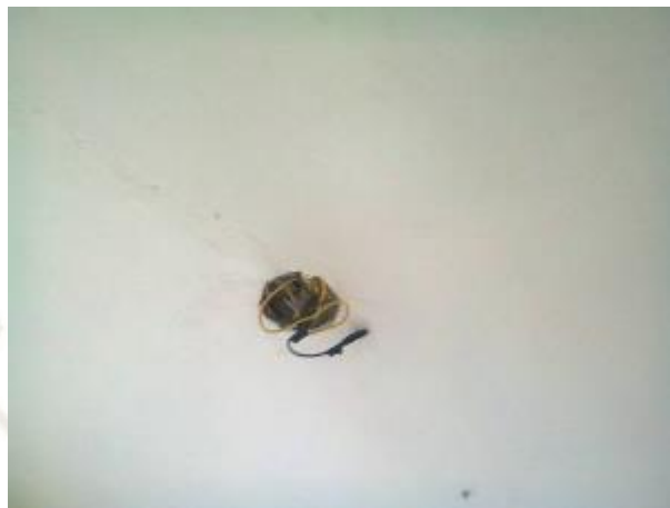
Foto N° 200 (CE4) Cajas de paso
