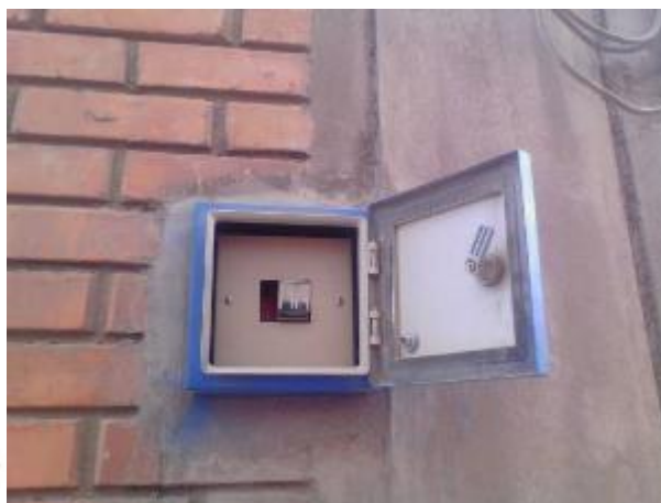
Foto N° 140 (CE2) Tableros eléctricos
