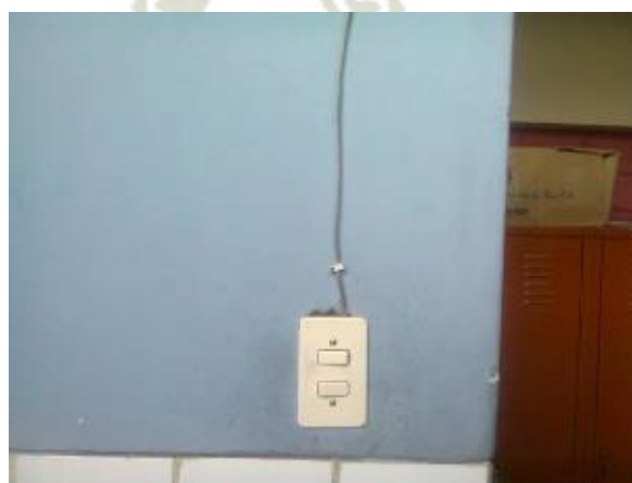
Foto N° 196 (CE4) Conductores eléctricos
