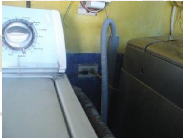
Foto N° 97 Tomacorrientes y enchufes
