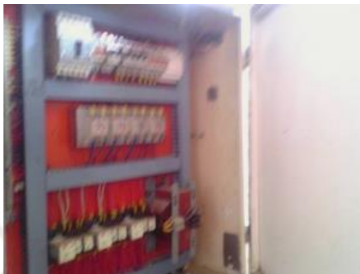
Foto N° 131 (CE2) Tableros eléctricos
