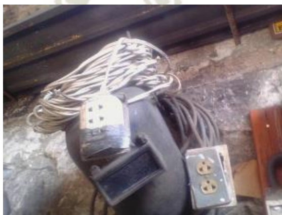
Foto N° 172 (CE3) Conductores eléctricos
