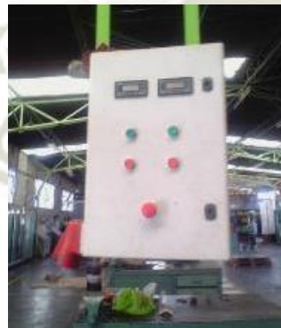
Foto N° 127 (CE2) Tableros eléctricos
