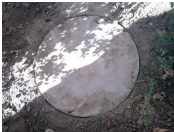
Foto N° 204 (CE4) Pozo a tierra
