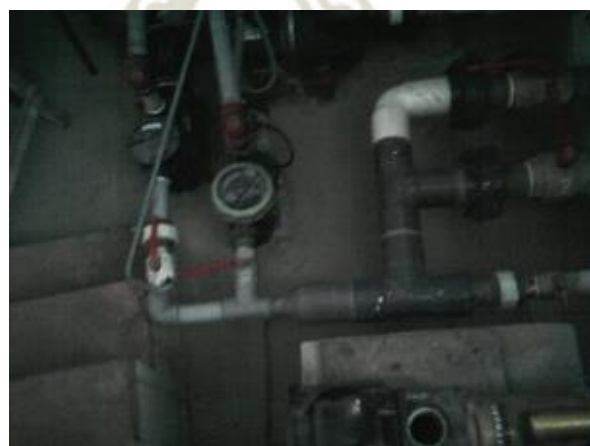
Foto N° 184 (CE4) Motores eléctricos
