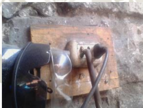
Foto N° 165 (CE3) Tomacorrientes y enchufes
