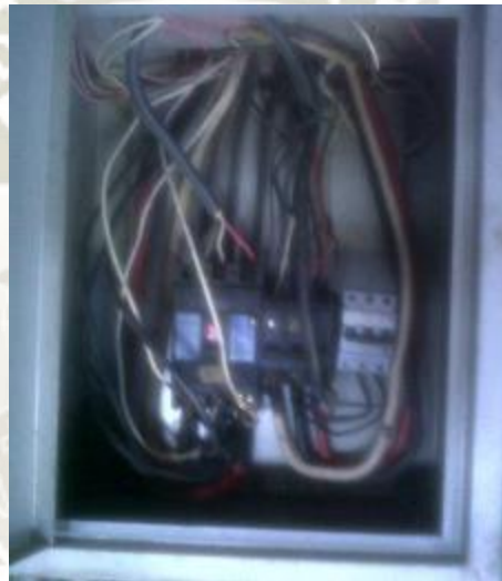
Foto N° 43 Tableros eléctricos Fuente: Elaboración propia
