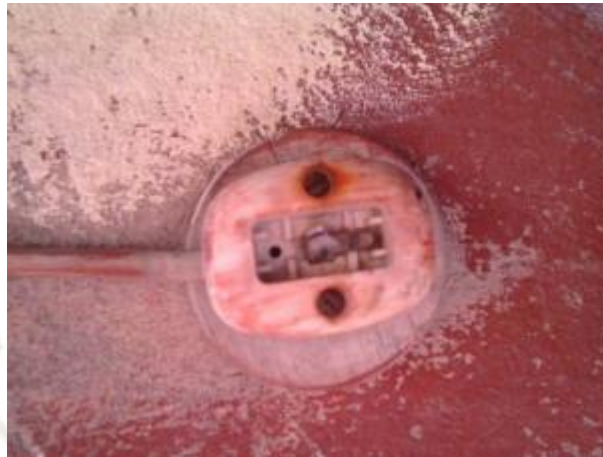
Foto N° 185 (CE4) Interruptores eléctricos
