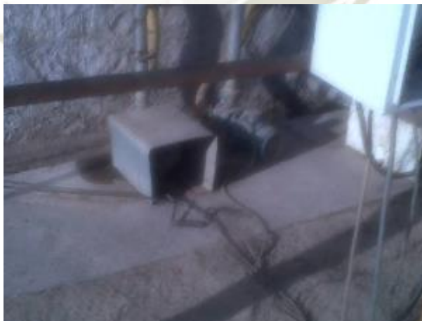
Foto N° 87 Conductores eléctricos Fuente: Elaboración propia
