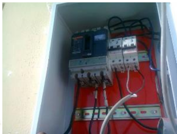
Foto N° 192 (CE4) Tableros eléctricos
