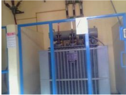
Foto N° 146 (CE2) Subestación eléctrica
