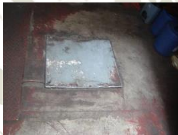
Foto N° 111 Pozos a tierra Fuente: Elaboración propia
