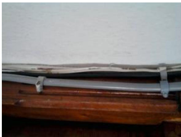
Foto N° 182 (CE4) Conductores eléctricos
