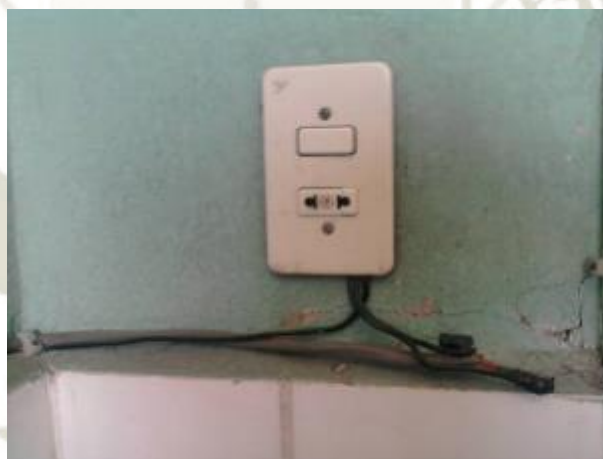
Foto N° 181 (CE4) Conductores eléctricos
