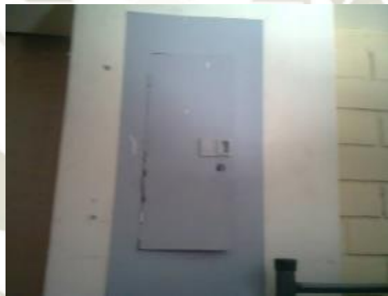
Foto N° 191 (CE4) Tableros eléctricos
