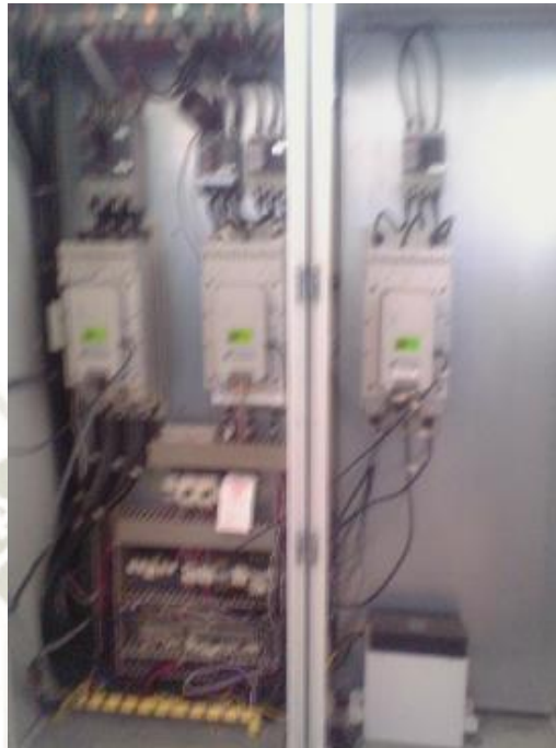
Foto N° 136 (CE2) Tableros eléctricos
