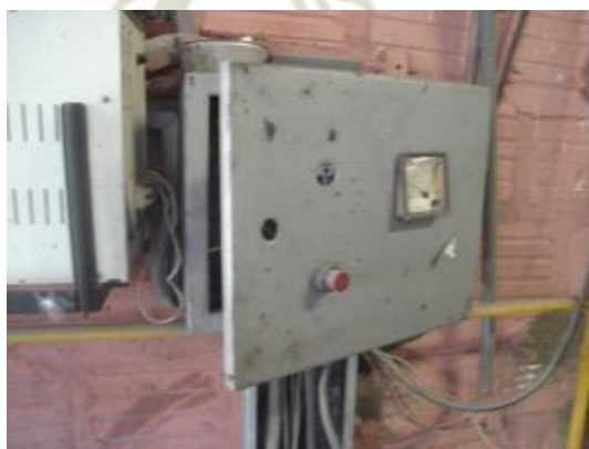
Foto N° 7 Tableros eléctricos Fuente: Elaboración propia
