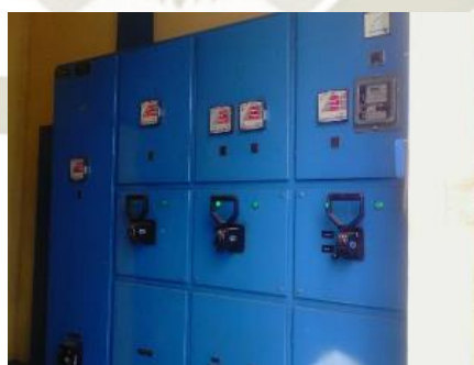
Foto N° 124 (CE2) Tableros eléctricos
