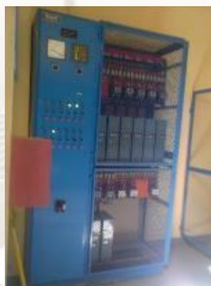
Foto N° 145 (CE2) Subestación eléctrica
