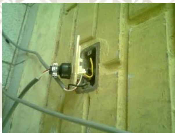
Foto N° 203 (CE4) Tomacorrientes eléctricos
