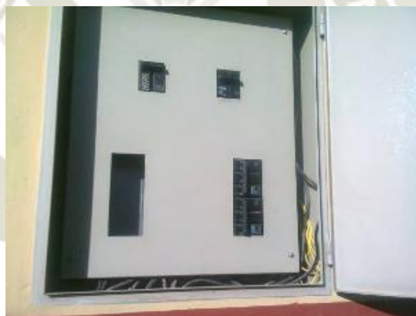
Foto N° 188 (CE4) Tableros eléctricos
