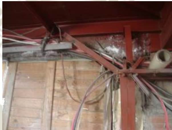
Foto N° 82 Conductores eléctricos Fuente: Elaboración propia
