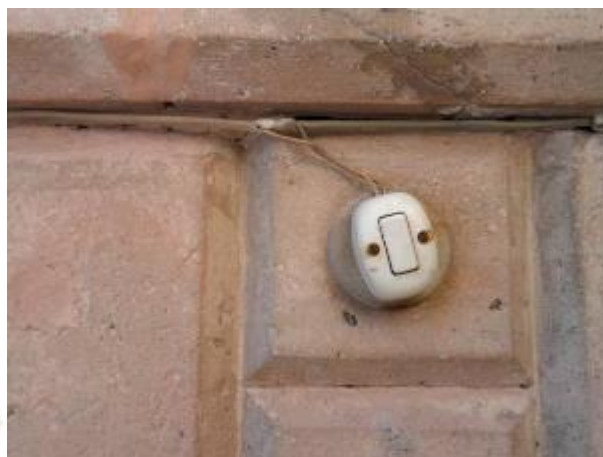
Foto N° 180 (CE4) Conductores eléctricos
