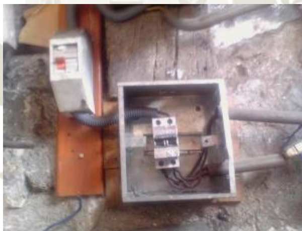
Foto N° 161 (CE3) Tableros Eléctricos
