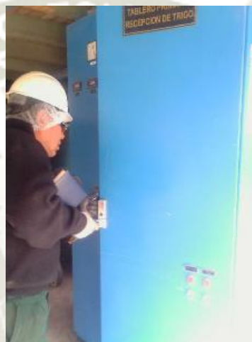
Foto N° 126 (CE2) Tableros eléctricos
