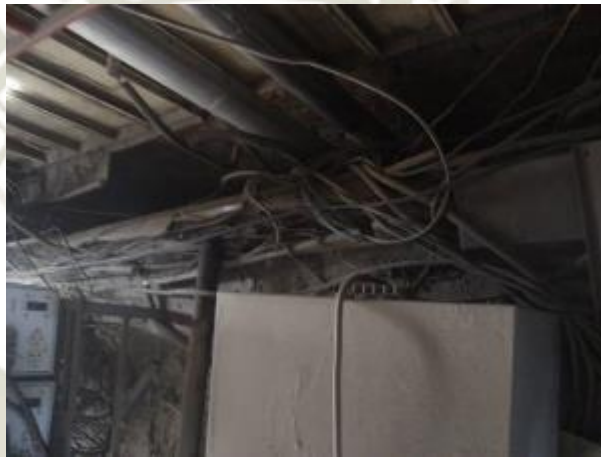
Foto N° 86 Conductores eléctricos Fuente: Elaboración propia
