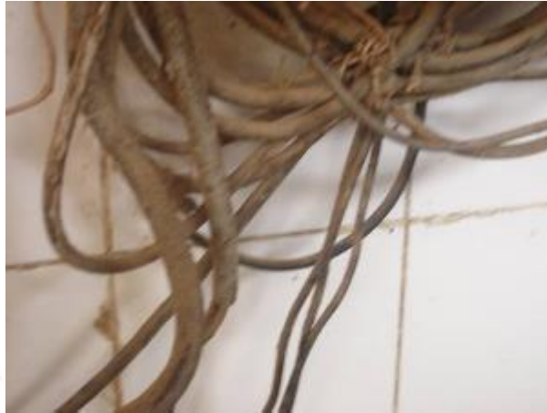
Foto N° 85 Conductores eléctricos Fuente: Elaboración propia
