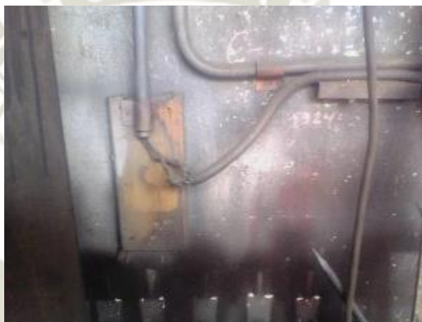
Foto N° 163 (CE3) Conductores eléctricos
