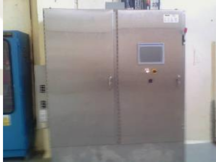
Foto N° 121 (CE2) Tableros eléctricos
