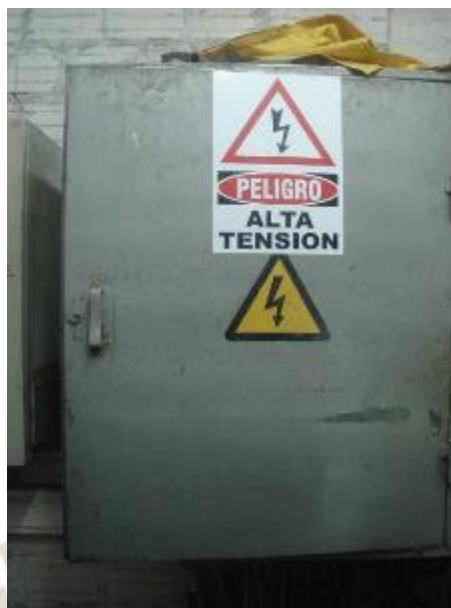
Foto N° 90 Cajas de paso Fuente: Elaboración propia
