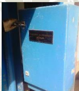
Foto N° 123 (CE2) Tableros eléctricos
