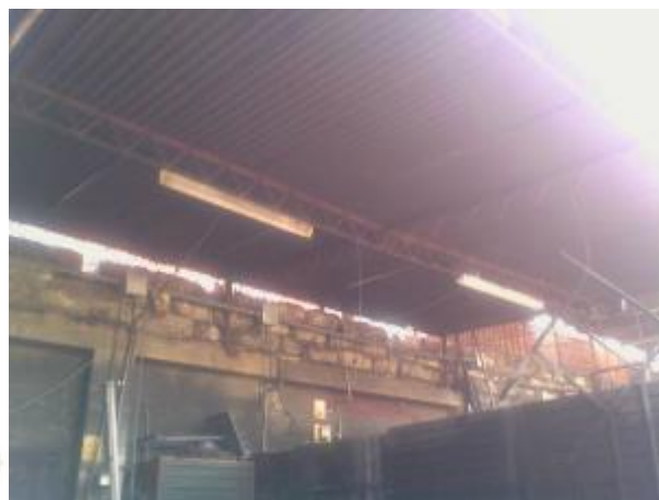
Foto N° 164 (CE3) Conductores eléctricos
