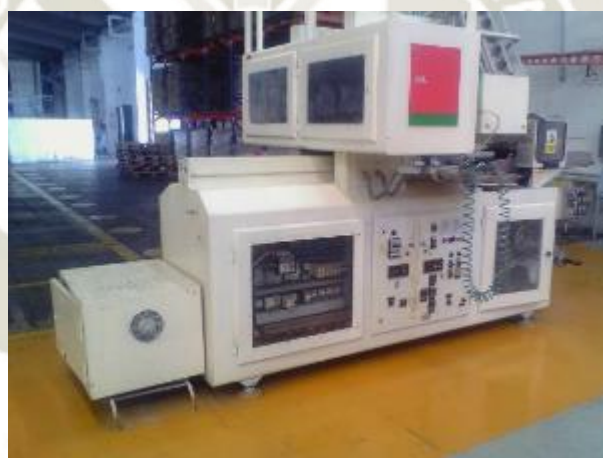
Foto N° 151 (CE2) Equipos eléctricos
