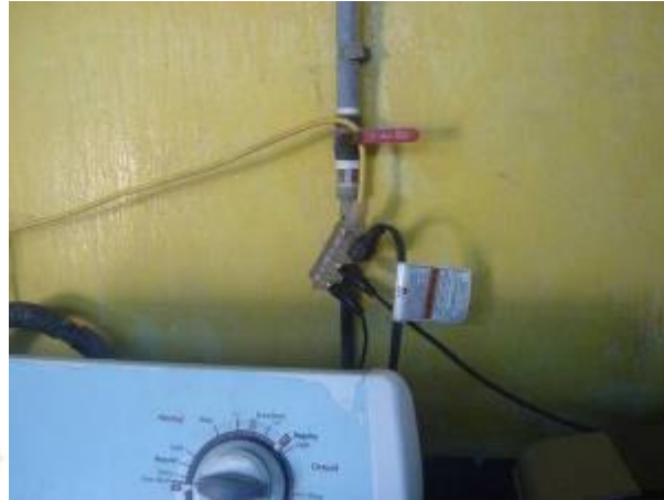
Foto N° 96 Tomacorrientes y enchufes
