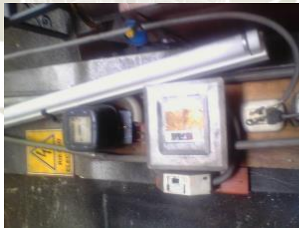
Foto N° 159 (CE3) Tableros Eléctricos
