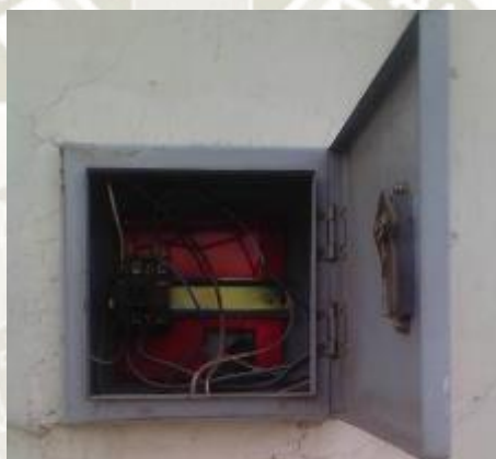
Foto N° 129 (CE2) Tableros eléctricos
