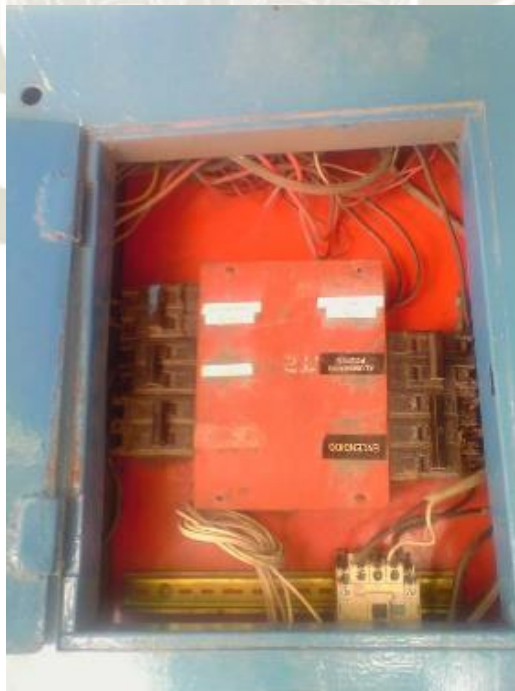
Foto N° 137 (CE2) Tableros eléctricos
