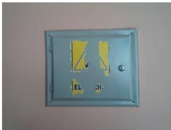
Foto N° 175 (CE4) Tableros eléctricos
