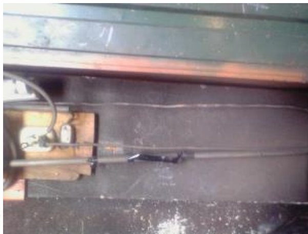
Foto N° 162 (CE3) Conductores eléctricos
