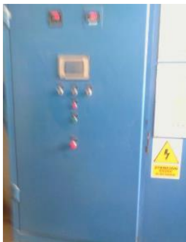
Foto N° 122 (CE2) Tableros eléctricos
