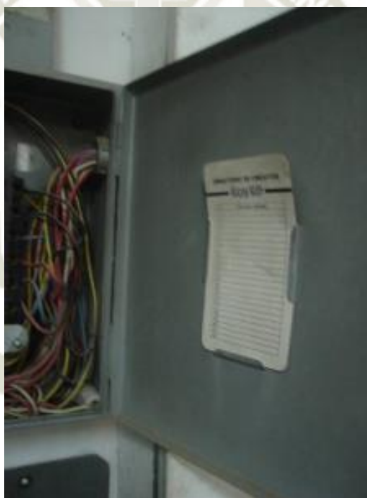
Foto N° 48 Tableros eléctricos Fuente: Elaboración propia
