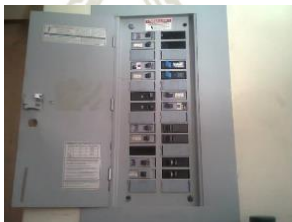
Foto N° 189 (CE4) Tableros eléctricos
