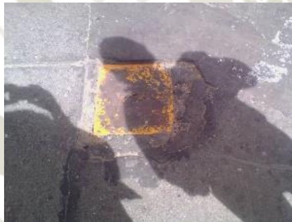
Foto N° 153 (CE2) Pozos a tierra
