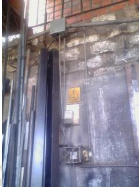
Foto N° 158 (CE3) Tableros Eléctricos
