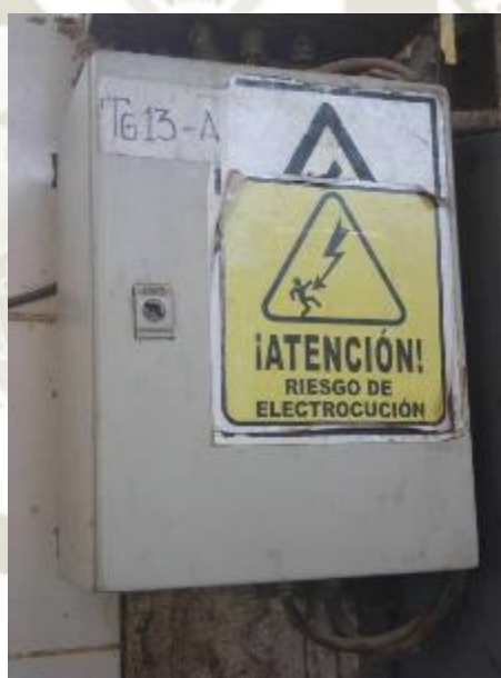
Foto N° 91 Cajas de paso Fuente: Elaboración propia
