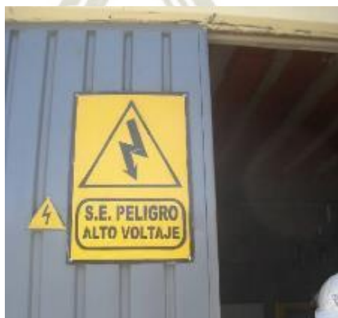
Foto N° 106 Subestación eléctrica Fuente: Elaboración propia
