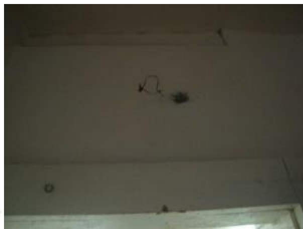
Foto N° 92 Cajas de paso
