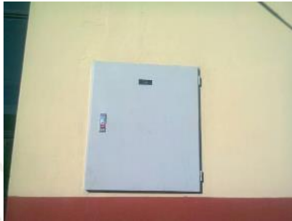
Foto N° 190 (CE4) Tableros eléctricos
