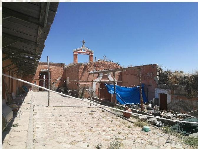
Imagen 28: Arquitectura del hotel deteriorada.
