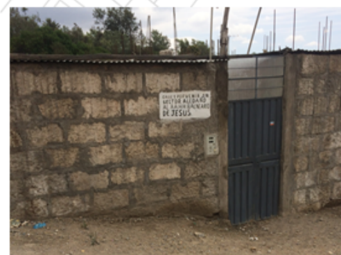
IMG.6: Mayoría de viviendas en mal estado FUENTE: Elaboración Propia
