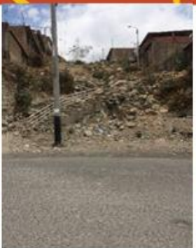
IMG.4: Malos accesos. FUENTE: Propia
