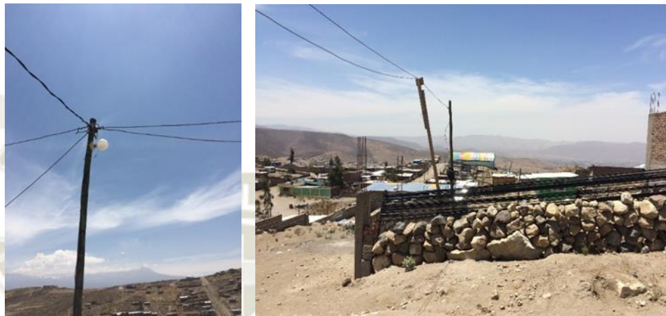
Imagen 10: Deficiente alumbrado en zona los Rosales.
