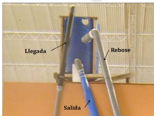
Figura 6. 5, Tanque elevado 200 litros, Ubicación final PA
