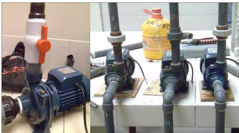
Figura 6. 12, Banco de bombas; una bomba de 2HP y tres de 0.5HP. PA
