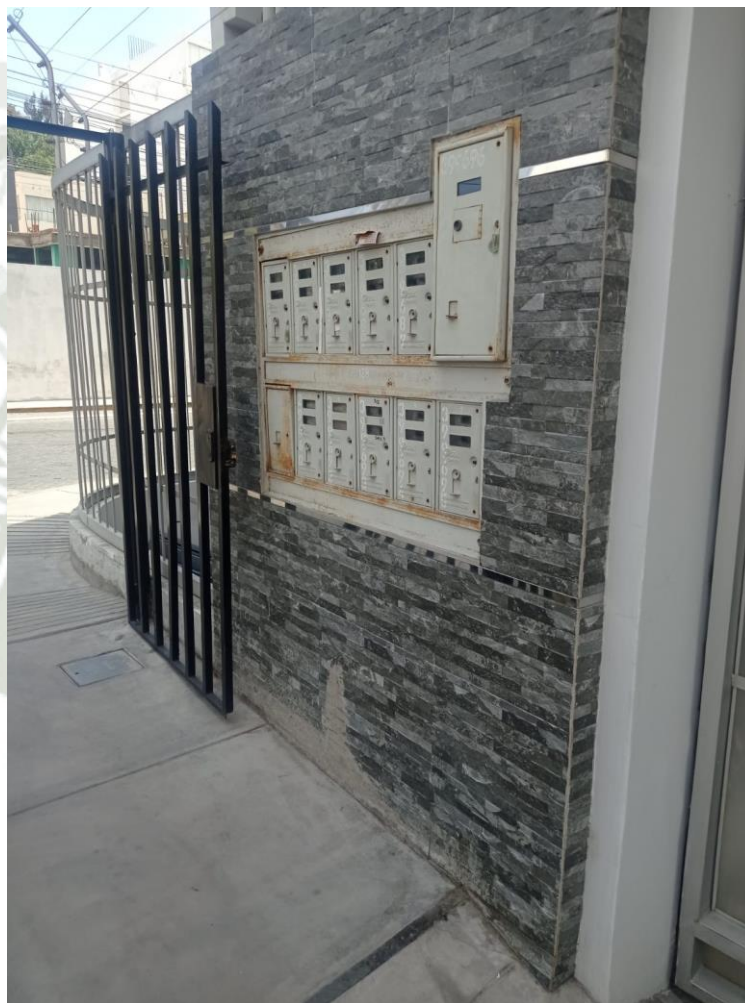
Figura 3.18 Vista de zona de medidores de un edificio
