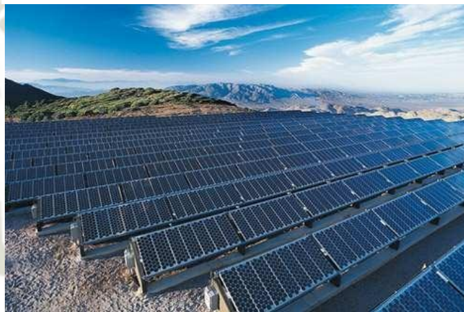
Figura 1. Campo solar de placas fotovoltaicas
