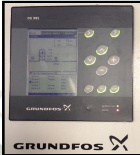
Fotografía 22 Tablero bombas Grundfos
