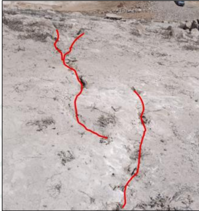
Figura 10. Fisura en tramo Faja CVC-013, Prog. 0+350 a 5 metros lado derecho
