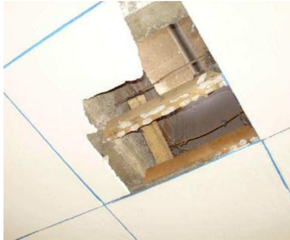
FOTOGRAFÍA 3.6 - DESPRENDIMIENTO COBERTURA TECHO
