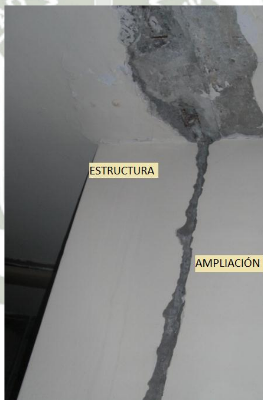
FOTOGRAFÍA 3.17 - MUESTRA GRIETA EN AMPLIACIÓN
