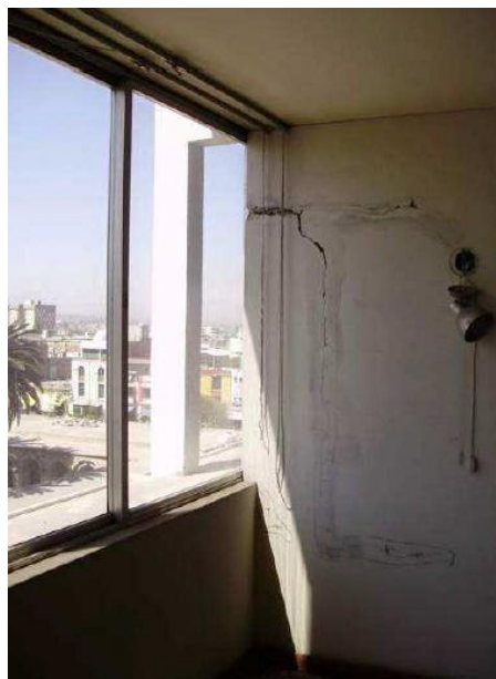
FOTOGRAFÍA 3.12 - TABIQUE TRANSVERSAL AGRIETADO
