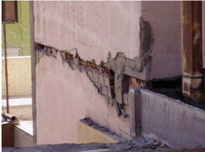
FOTOGRAFÍA 3.14 - TABIQUE CON DAÑO 4 PISO
