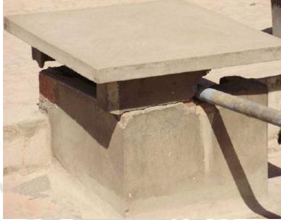
FOTOGRAFÍA 3.1-TAPA DE DUCTO DAÑADA
