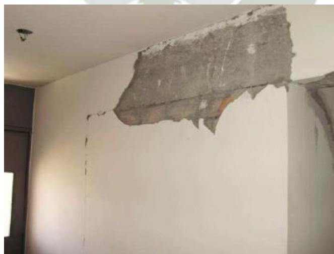
FOTOGRAFÍA 3.9 - PISO 10 DAÑO TABIQUE VIGA EJE "P"
