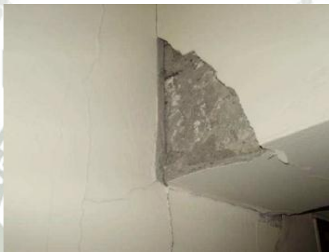
FOTOGRAFÍA 3.8-DAÑO REPETITIVO TABIQUE/VIGA
