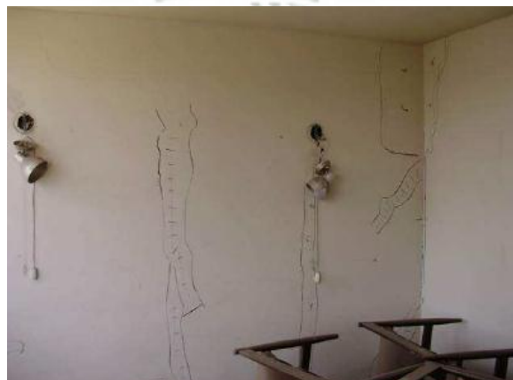
FOTOGRAFÍA 3.11-TABIQUE EN HABITACIÓN DAÑADO
