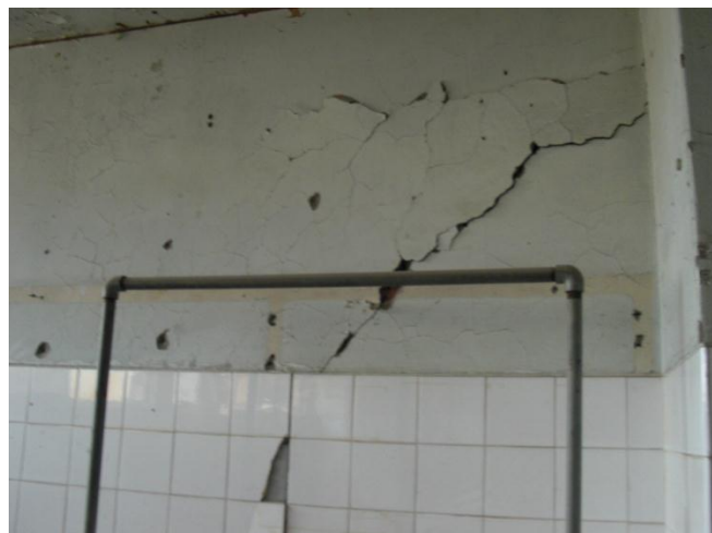
FOTOGRAFÍA 3.16 - TABIQUE LAVANDERIA AGRIETADO
