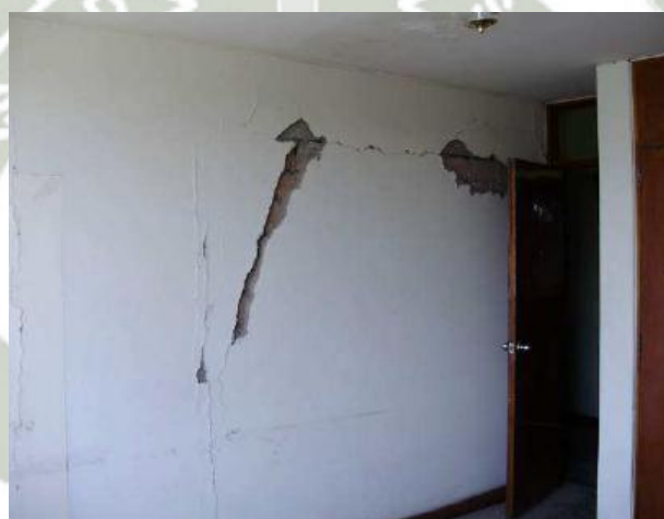
FOTOGRAFÍA 3.13 - TABIQUE TRANSVERSAL AGRIETADO
