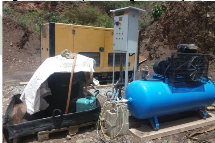
Figura N°20: Grupo electrógeno - compresora
