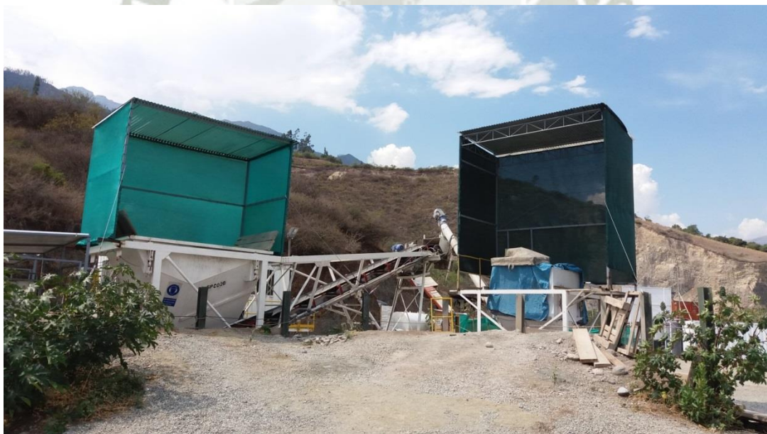
Figura N°42: Cobertura de tolvas
