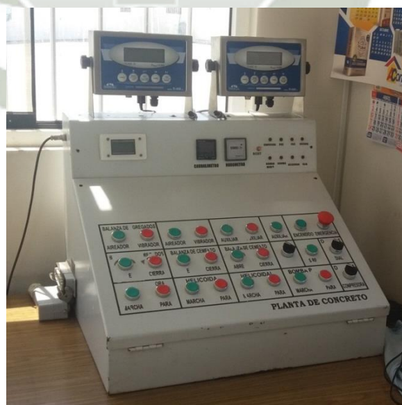
Figura N°13: Tablero de control
