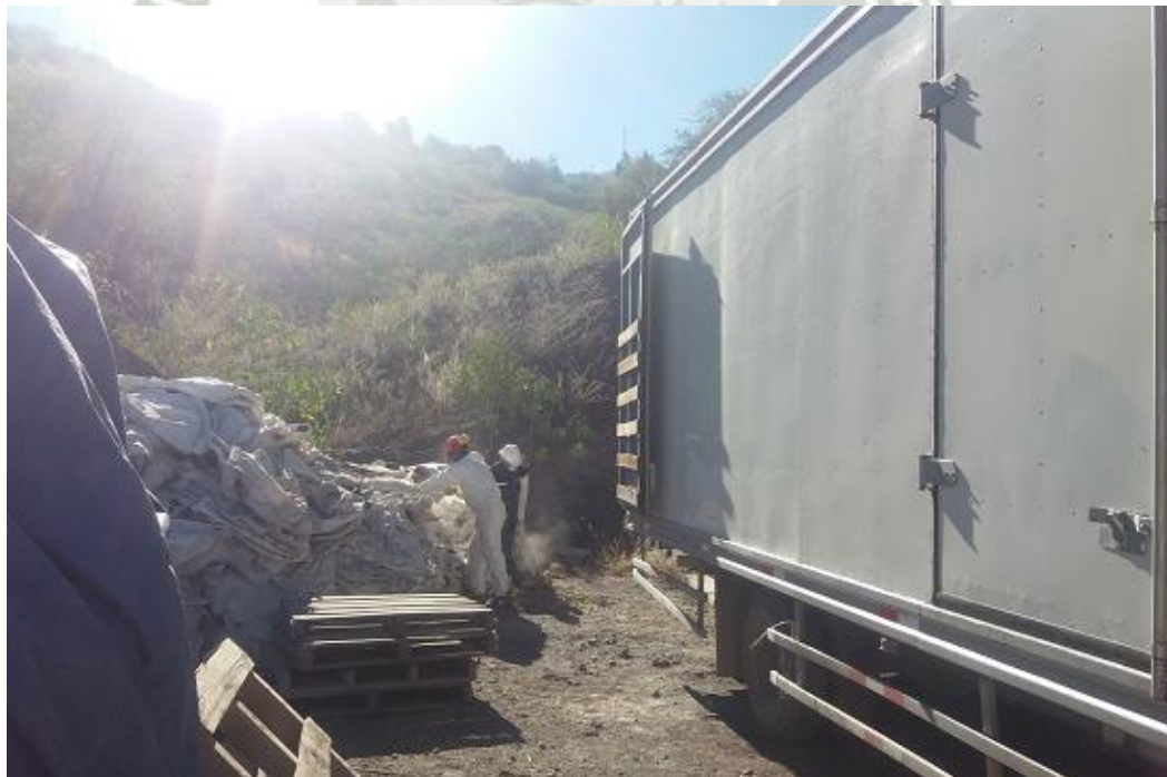
Figura N° 46: Disposición de residuos
