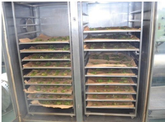
Fotografía N°9. Cámara de estufa
