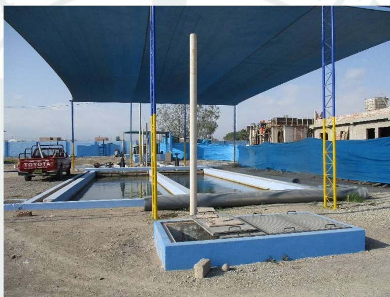
Figura 7: Planta de Tratamiento de Agua Potable N° 1.
