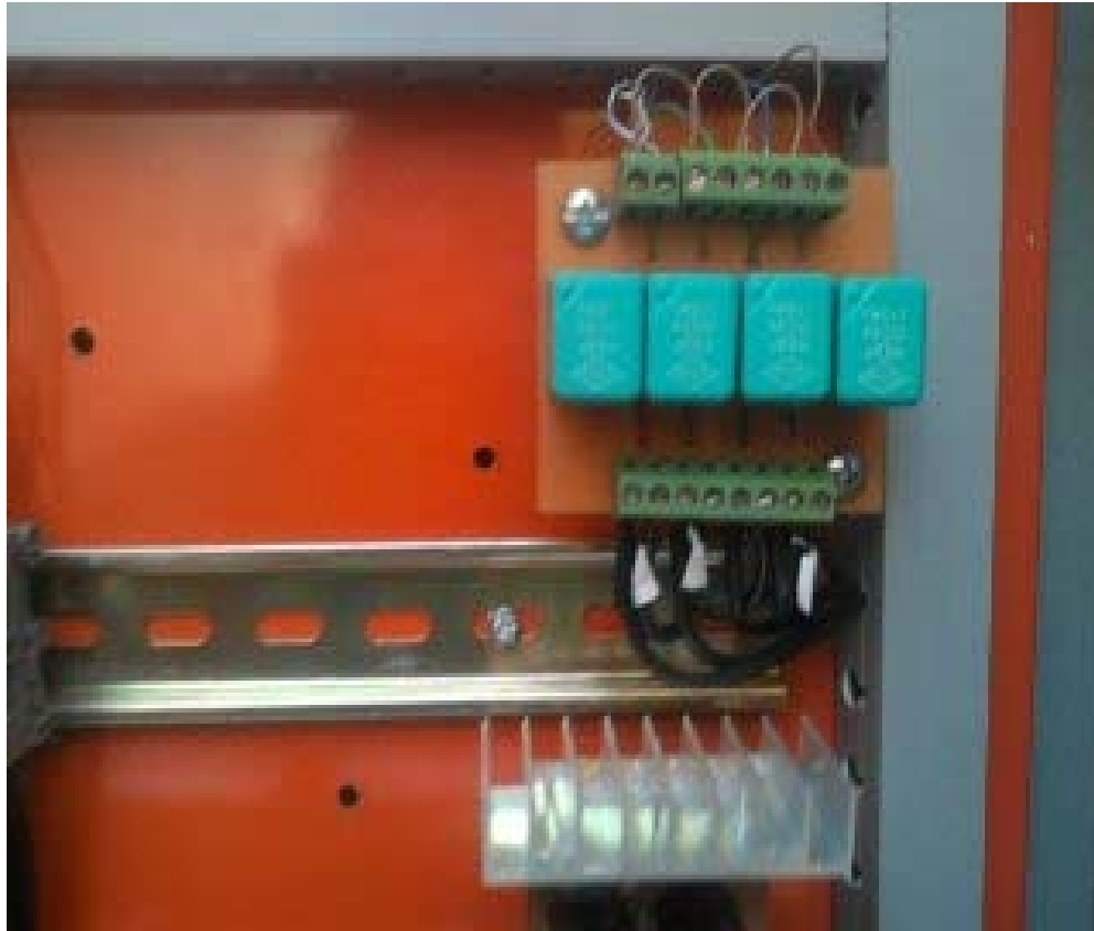
Figura 74 Circuito Instalado en Tablero
