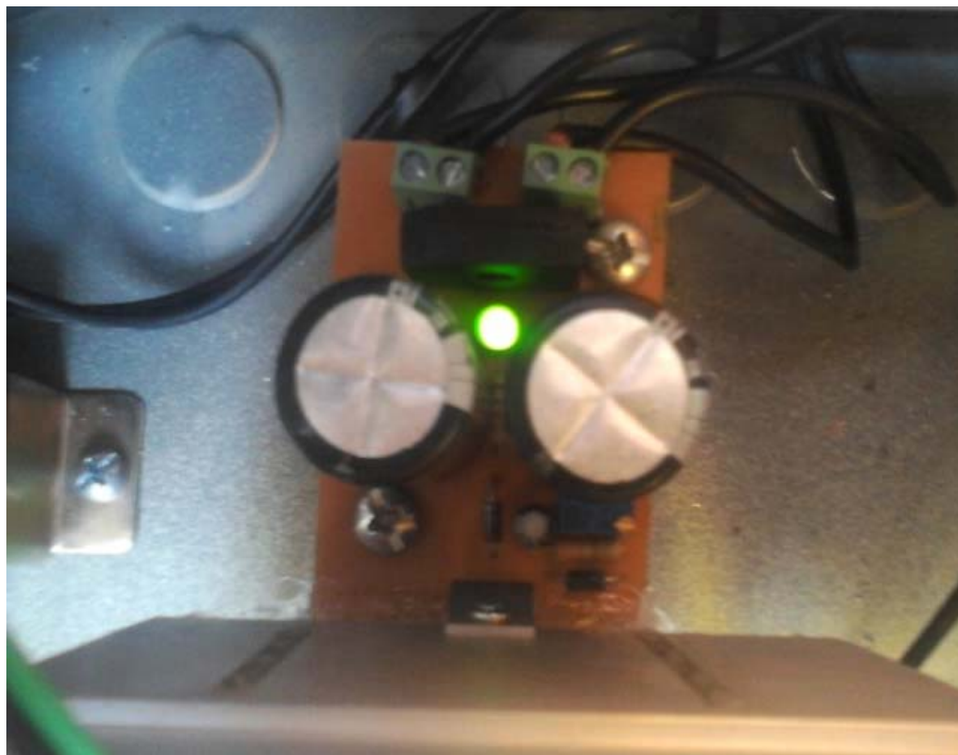
Figura 85 Equipo Instalado En Tablero
