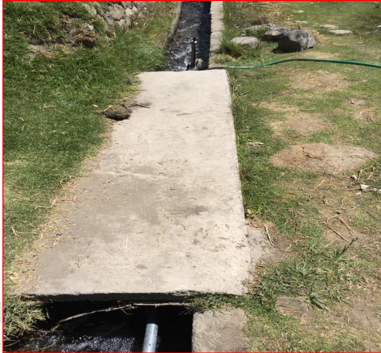
Figura N° 48: Tubería de impulsión Fuente: Propia
