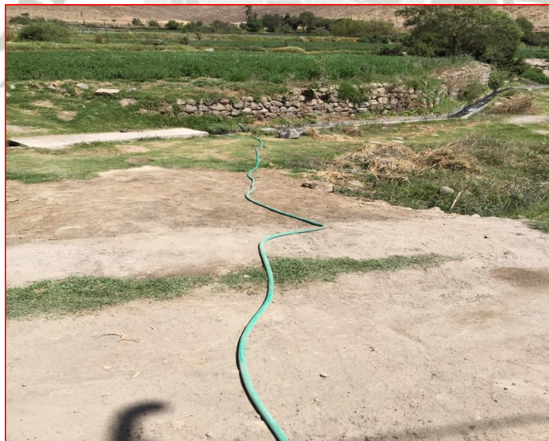
Figura N° 49: Toma de tubería de descarga Fuente: Propia
