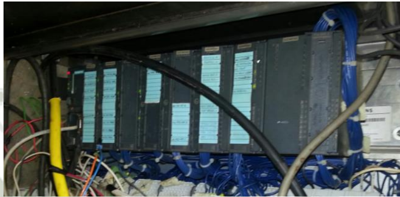
Fig 5.12 PLC Simenes S7-315 (estación principal)
