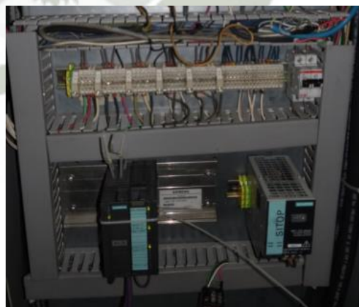
Fig 5.8 Interface IM 153-1 (estación drawworks )
