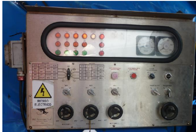
Fig.5.4 Consola de perforacion
