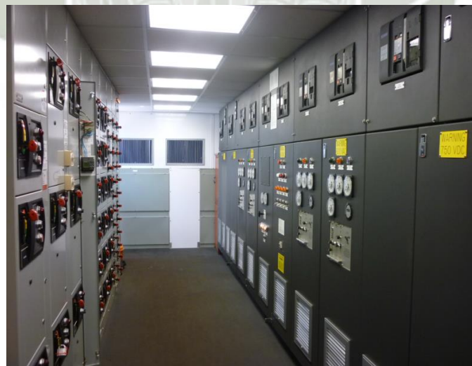
Fig 5.89 Cabina SCR marca IEC del Ptx-28
