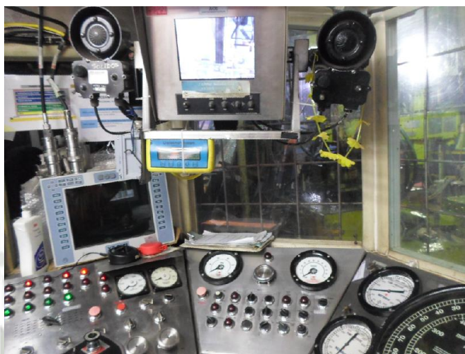
Fig 5.86 Nueva consola del perforador Ptx-28
