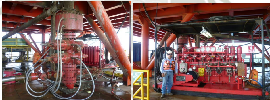
Fig 6.1 BOP y acumulador de un equipo de perforación
