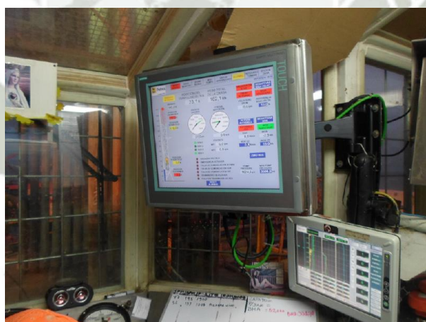
Fig 5.87 Montaje de Panel View MP377 19" Touch en consola
