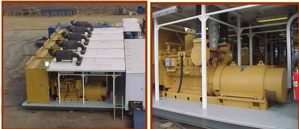
Fig 3.4 Generadores Caterpillar de 1400HP
