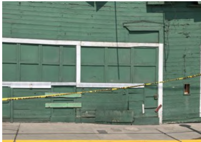
Imagen 68: Instalaciones eléctricas al descubierto y en malas condiciones
