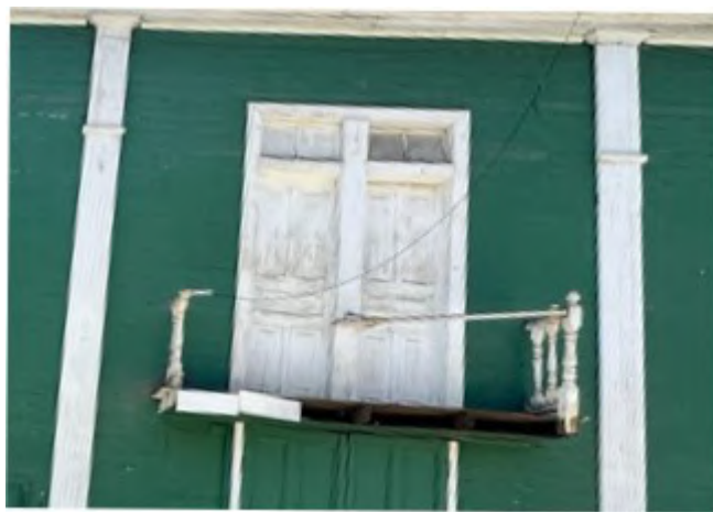
Imagen 61: Elementos faltantes en balcones.
