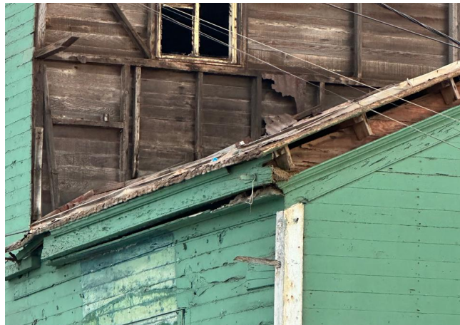
Imagen 67: Suciedad y elementos percutidos en esquinas
