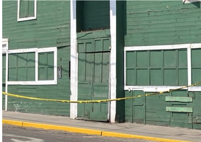
Imagen 65: Fisuras de puertas
