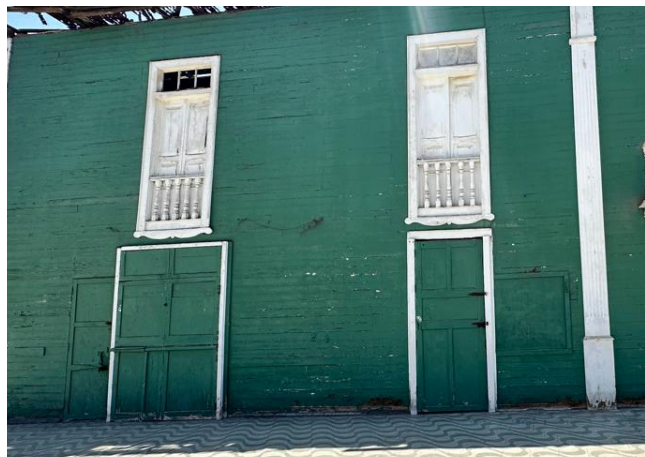
Imagen 60: Desprendimiento y suciedad
