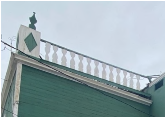
Imagen 66: Desprendimiento de elementos ornamentales
