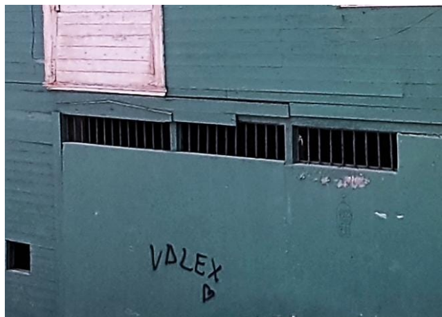
Imagen 77: Oxidación de elementos metálicos
