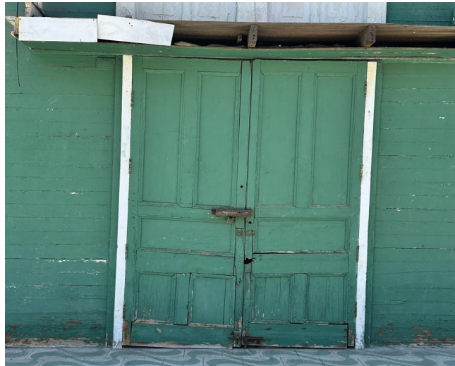
Imagen 59: Desprendimiento y desgaste alrededor de vanos
