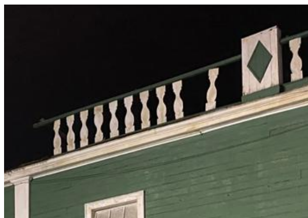
Imagen 62: Elementos faltantes e instalaciones eléctricas en mal estado.
