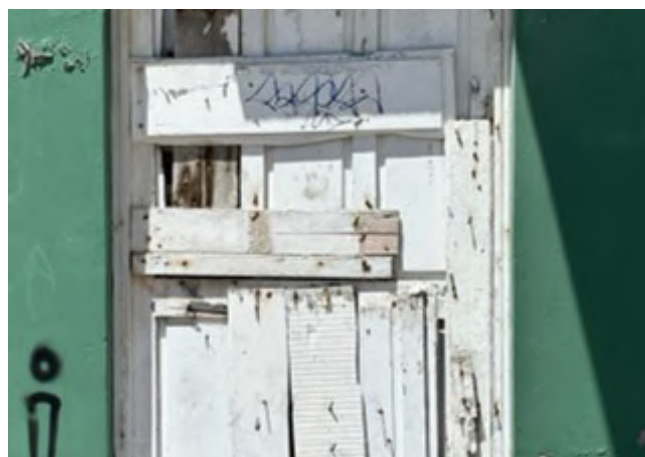
Imagen 78: Desprendimiento de la capa externa del material
