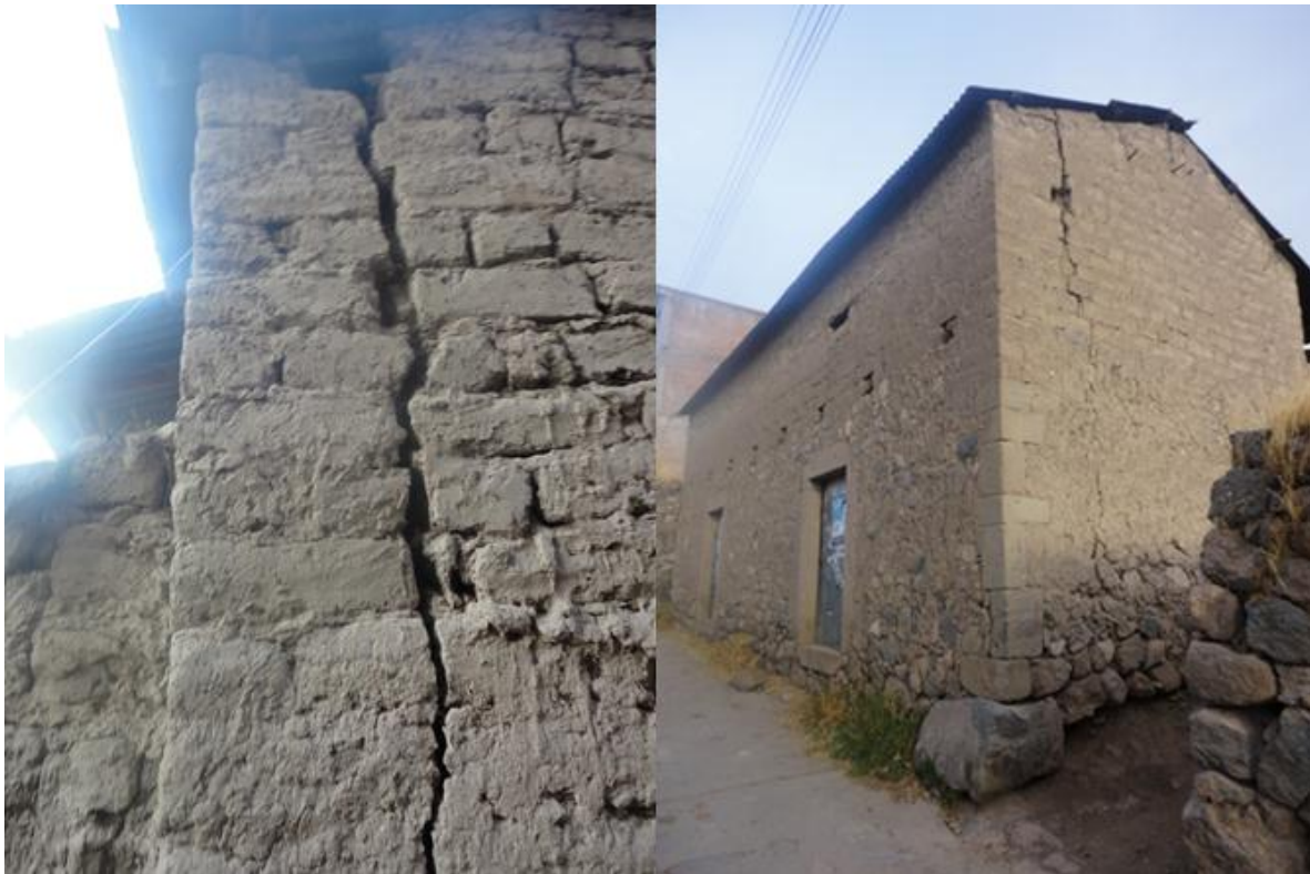
Figura 4.16 Grieta vertical en una vivienda de pircado y adobe.
