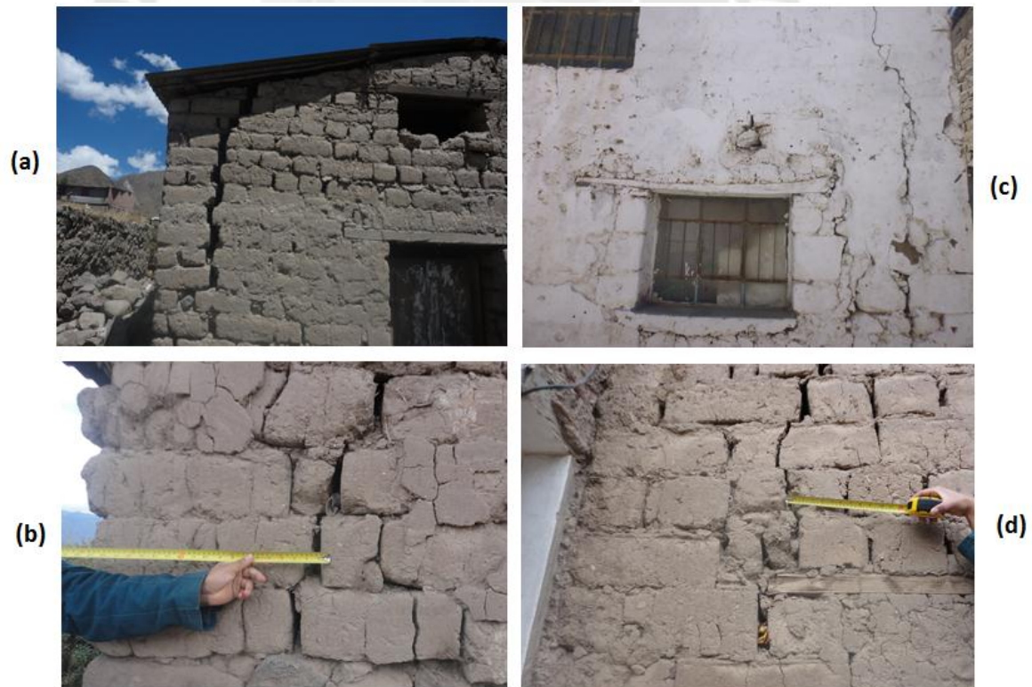
Figura 4.15 Grietas ocasionadas por sismos en muros de viviendas de adobe
