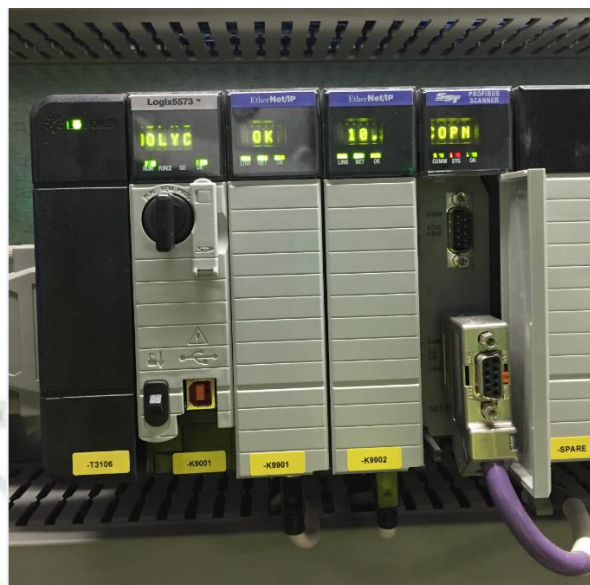
Figura 6.4.a PLC principal y tarjetas de interface de comunicación.
