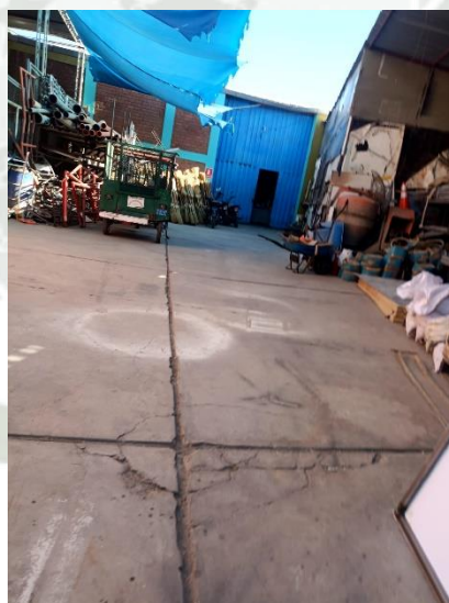
Figura 19. Falta de orden y limpieza en puesto de trabajo
