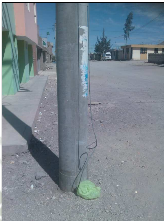
Foto N°15: Deficiencia 2072. Retenida en Mal Estado.
