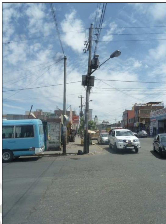
Foto N°09: Deficiencia 2004. Poste Inclinado Más de 5 grados.
