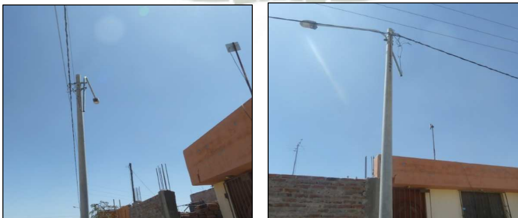
Figura 40: Deficiente orientación de las luminarias
