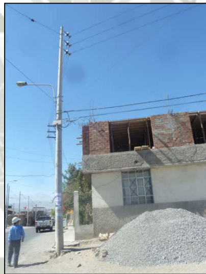
Figura 28: Deficiencia de Origen Externo, Edificación en proceso de construcción 2do piso – AMT HUNTER
