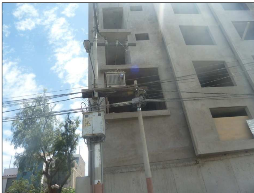
Foto N°12: Deficiencia 2026. Partes Rígidas Bajo Tensión No Protegidas, Incumplen Distancia de Seguridad Respecto a Líneas de Comunicación.
