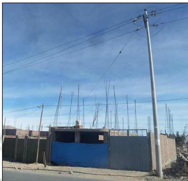
Foto N°07: Deficiencia 1072. Retenida en Mal Estado.
