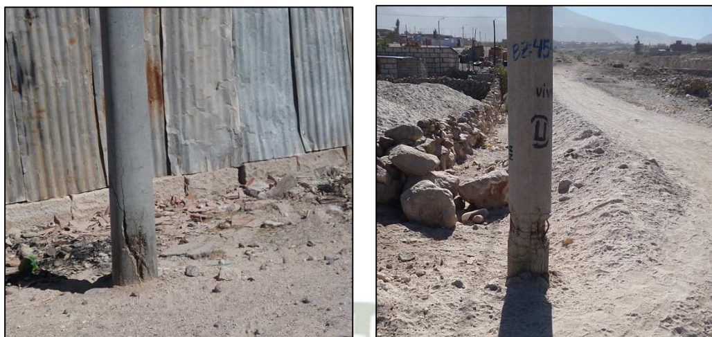
Foto N°01: Deficiencia 1002. Poste en Mal Estado de Conservación o Inapropiado Para la Función de Apoyo.
