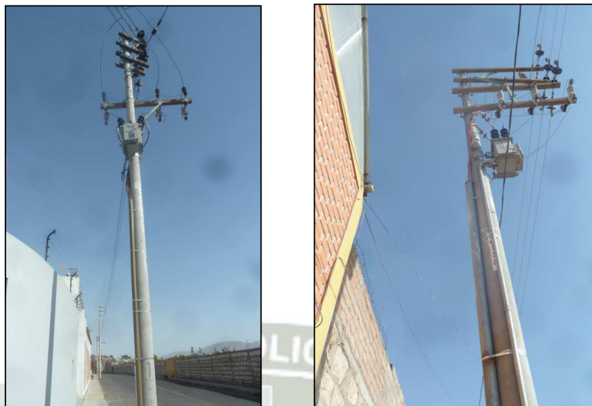
Figura 35: Deficiencia de Origen Interno, Transformix instalado incumpliendo DMS – AMT HUNTER
