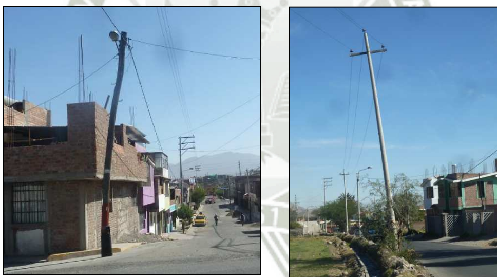
Foto N°02: Deficiencia 1008. Poste Inclinado Más de 5 grados.
