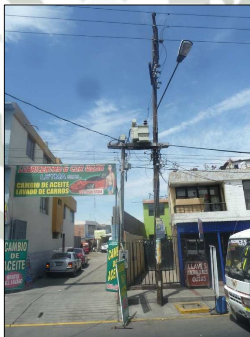
Foto N°08: Deficiencia 2002. Poste en Mal Estado de Conservación o Inapropiado Para la Función de Apoyo.
