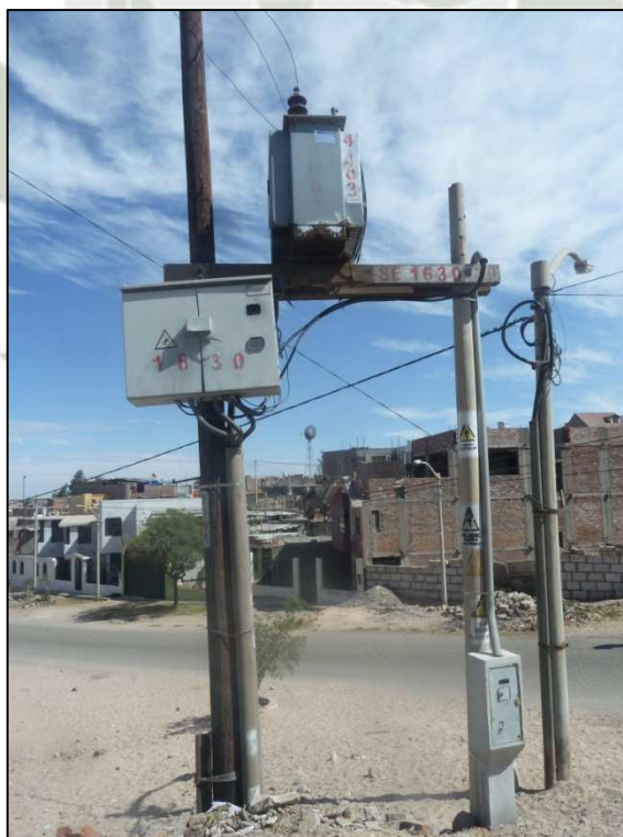
Foto N°16: Deficiencia 2106. Tablero y/o Caja Portamedidor Fácilmente Accesible, en Mal Estado.
