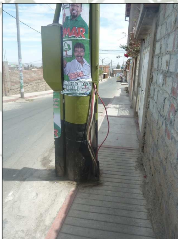
Foto N°13: Deficiencia 2034. Protección Mecánica de Cable MT Rota, Inexistente, Insuficiente o de Material Inadecuado.
