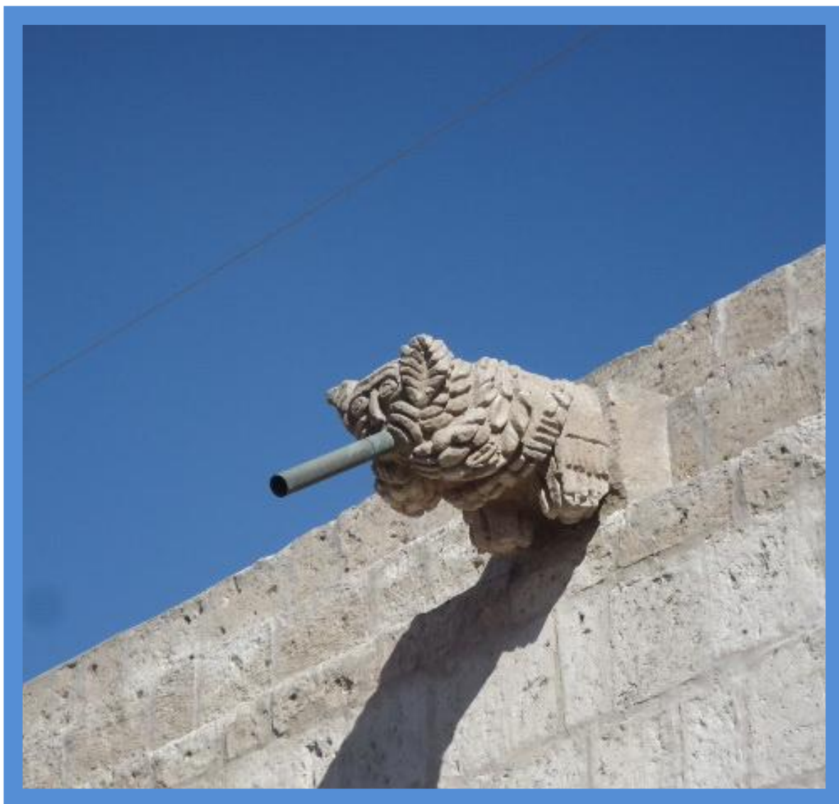
Imagen N°32: Gárgola Casona Tristán del Pozo
