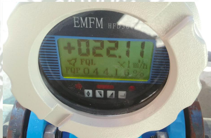
Figura 3.60: Medición de flujo de entrada a nido de hidrociclones.
