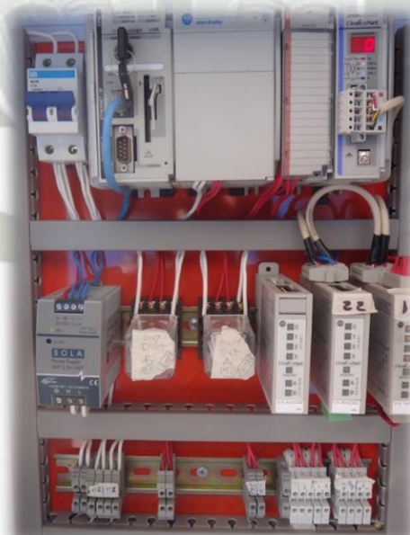
Figura 3.21: Tablero de control e instrumentación.
