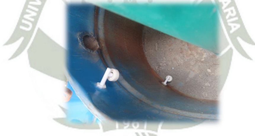
Figura 3.22: Ubicación de los sensores binarios.
