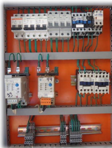
Figura 3.20: Tablero de fuerza de las bombas centrífugas.
