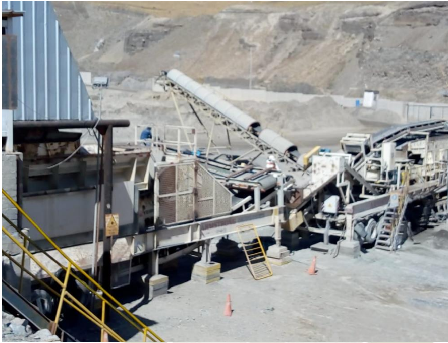
Figura 27 Repuestos deteriorados spag-13
