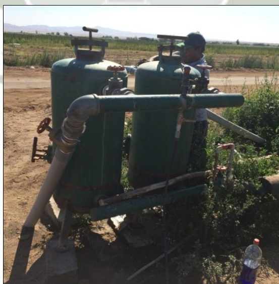
Centro de control o “Cabezal” de riego por goteo
