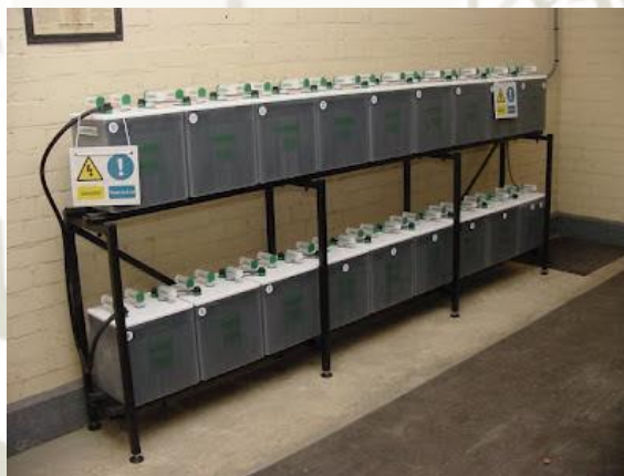
Figura 2-19: Banco de baterías.
