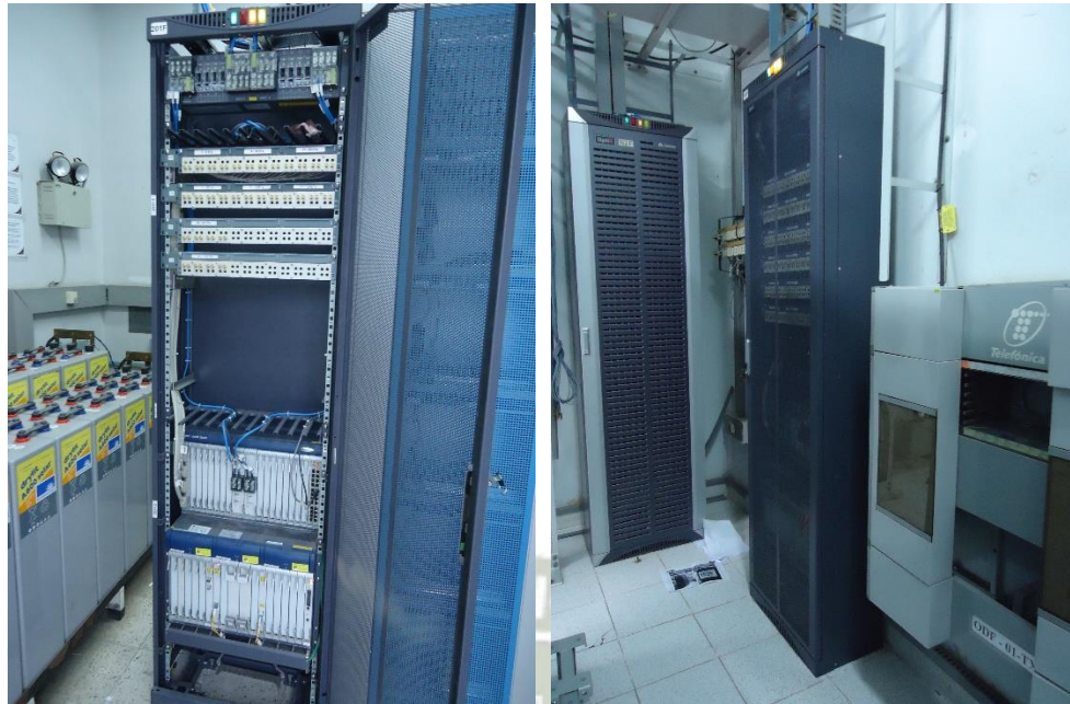
FIGURA 7-2 SALA DE EQUIPOS PUNTA DE BOMBON (EQUIPO OSN3500)
