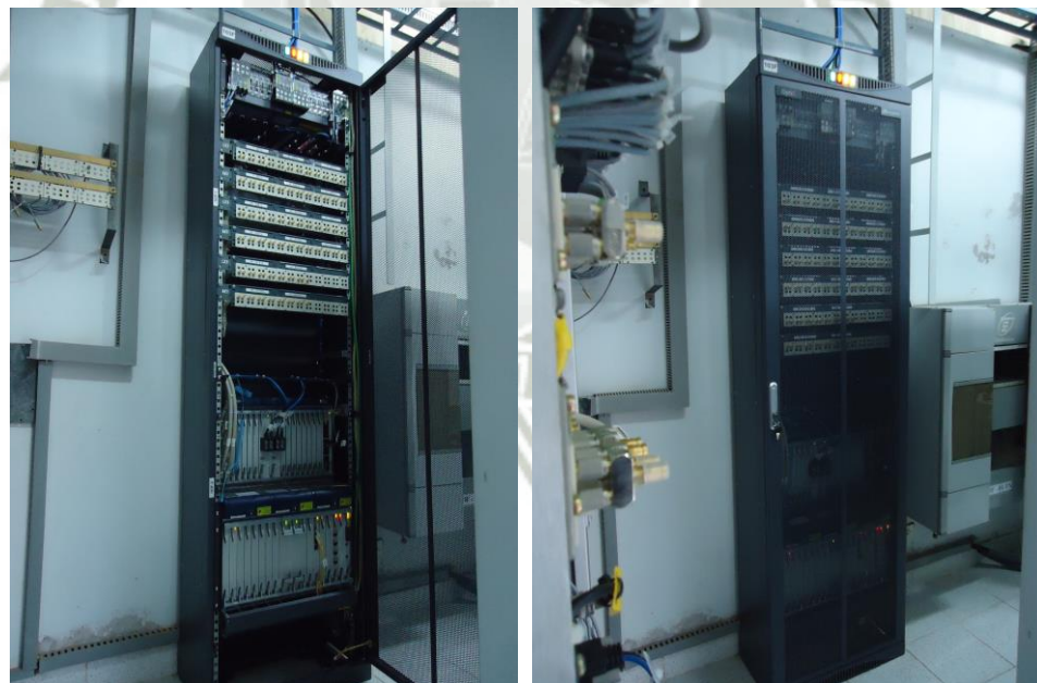
FIGURA 7-3 SALA DE EQUIPOS MEJIA (EQUIPO OSN3500)
