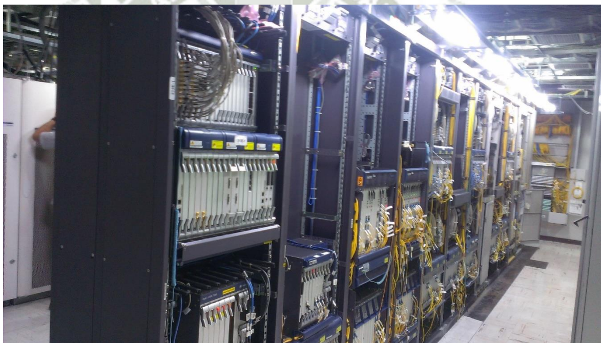
FIGURA 7-4 SALA DE EQUIPOS AREQUIPA_SW (EQUIPOS DWDM Y SDH)
