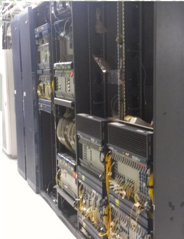
FIGURA 7-1 SALA DE EQUIPOS REDESUR - MOQUEGUA
