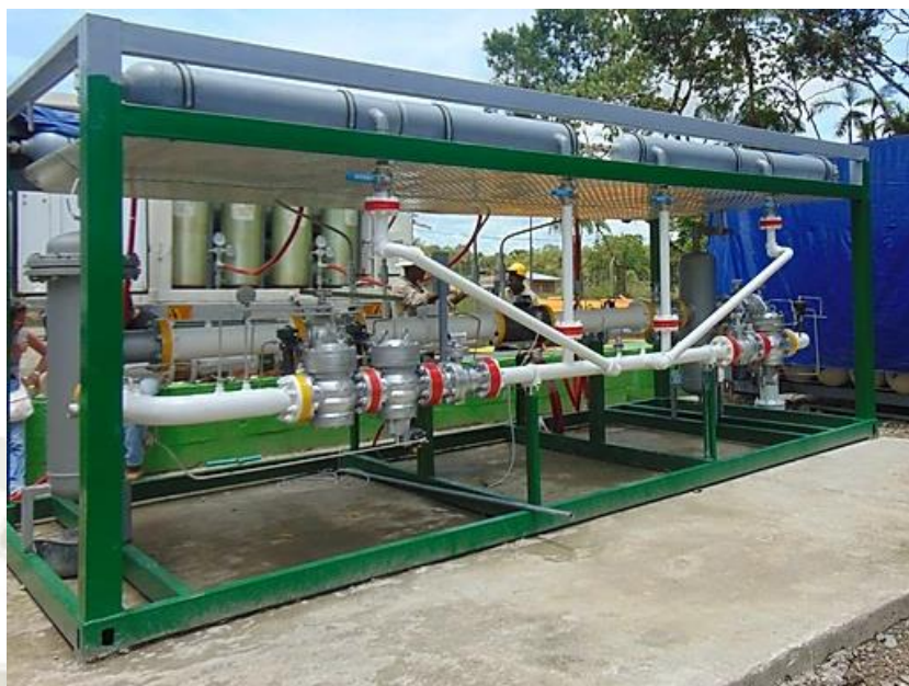
Figura 36. Estación de regulación de presión
