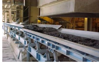
Figura 19: Transportador vibratorio mecánico para la conducción de carbón.
